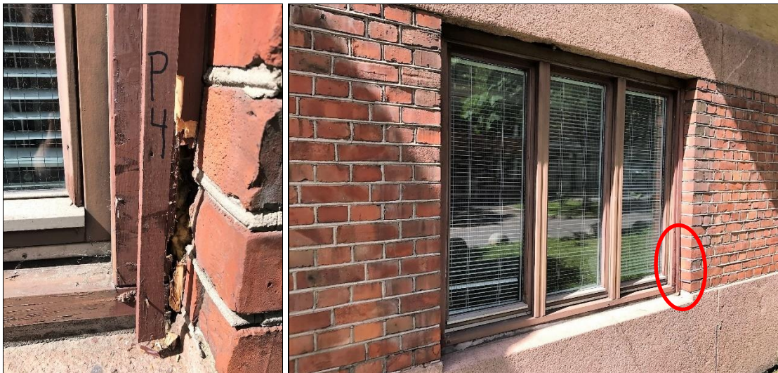
Figur 3: Fasade mot Gardeveien, hvor prøve 4 av brun fuge ble utført.
