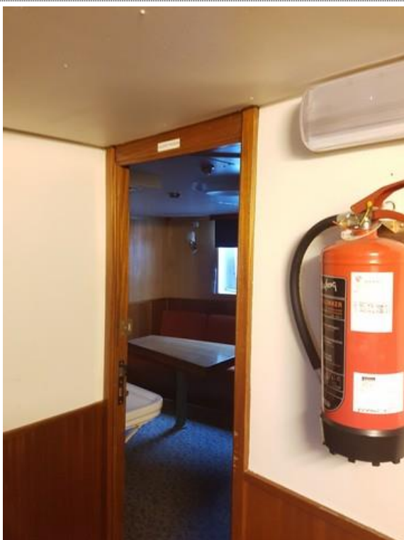
Bilde nr. 7 Inngang til lugar på båtdekk. Manuelt slokkeutstyr er utplassert.
