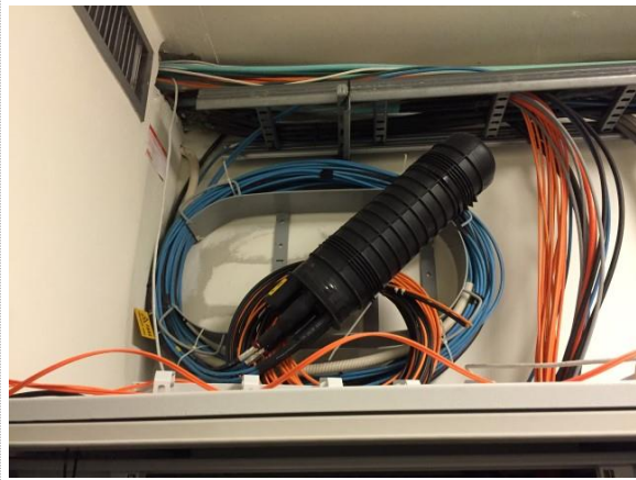
Bilde nr. 5.02 Fiber inn til bygget
