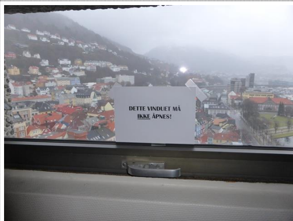
Bilde nr. 2.11 Vindu i 14. etasje med dårlig innfesting
