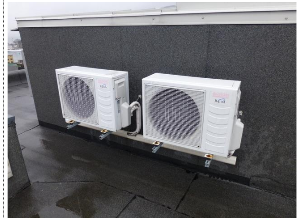
Bilde nr. 3.16 Kondensator til fancoil
