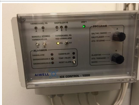
Bilde nr. 4.19 Styringssentral for varmekabler taksluk
