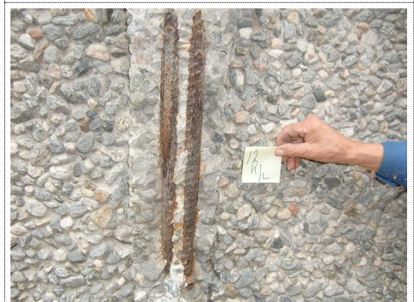
Bilde nr. 2.06 Armeringskorrosjon fasade
