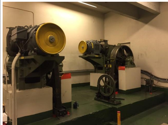
Bilde nr. 5.08 Heismaskinrom
