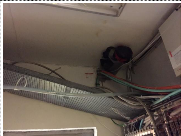
Bilde nr. 4.01 Eldre føringsveier i kjeller
