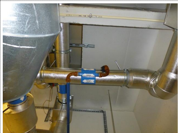
Bilde nr. 3.27 Rusten ekspansjonsledning
