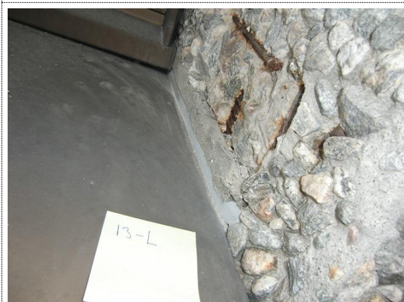
Bilde nr. 2.05 Armeringskorrosjon fasade
