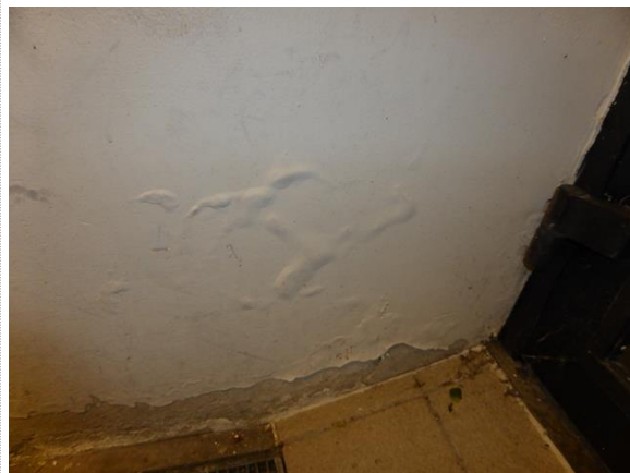
Bilde nr. 2.09 Utbløring vegg ved kjøkkeninngang
