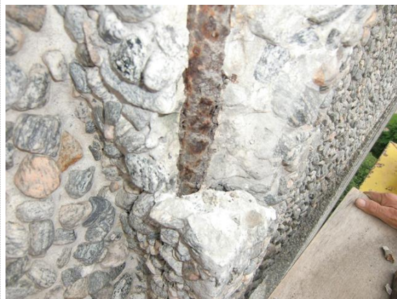
Bilde nr. 2.07 Armeringskorrosjon fasade
