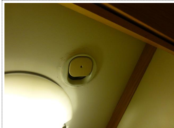
Bilde nr. 3.24 Gammel avtrekksventil
