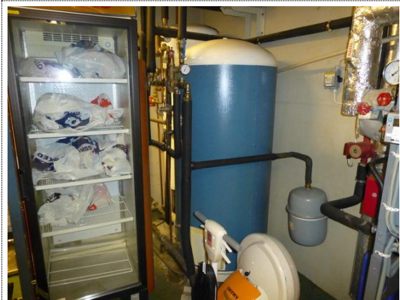
Bilde nr. 3.07 Varmtvannsbereder på 600 liter
