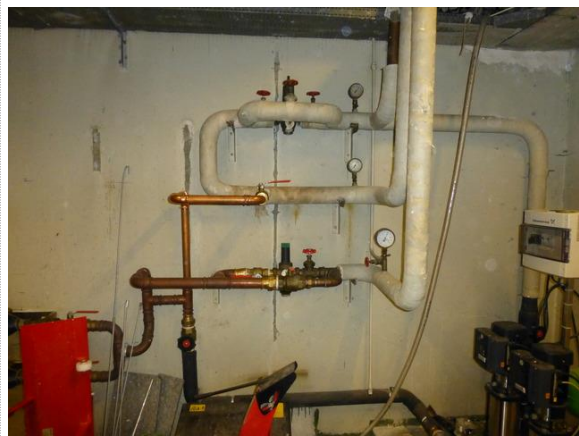
Bilde nr. 3.01 Sanitærledninger i kobber
