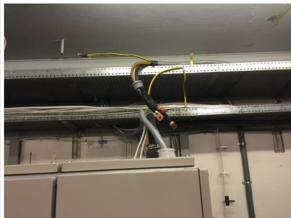
Bilde nr. 4.09 Eksempel på manglende fjerning av kabler
