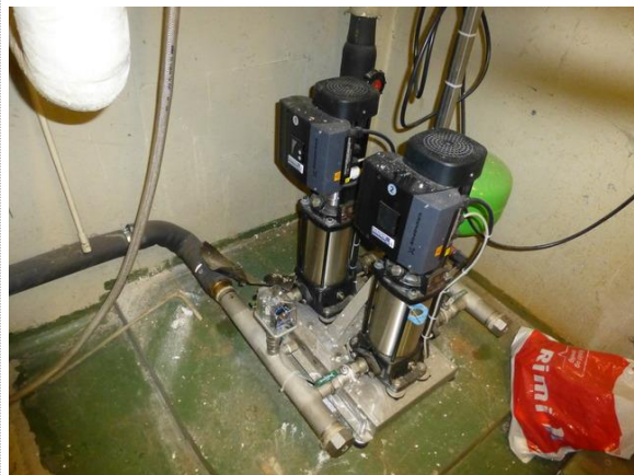
Bilde nr. 3.03 Trykkøkningspumper
