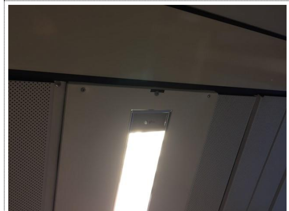
Bilde nr. 4.14 Lyssensor og bevegelsesføler integrert i armaturer på kontor
