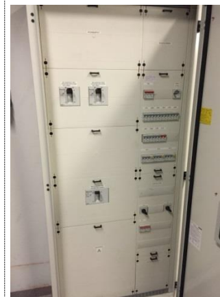
Bilde nr. 4.06 Ny tavle for ventilasjon
