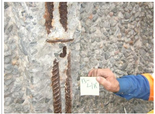
Bilde nr. 2.08 Armeringskorrosjon fasade
