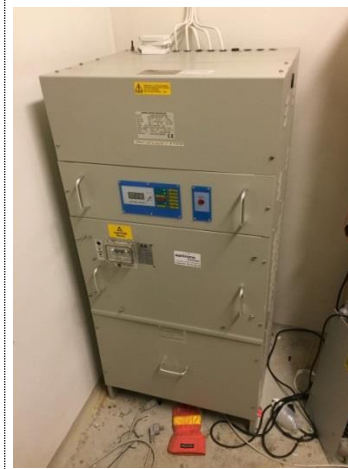
Bilde nr. 4.16 Nøddlyssentral i kjeller
