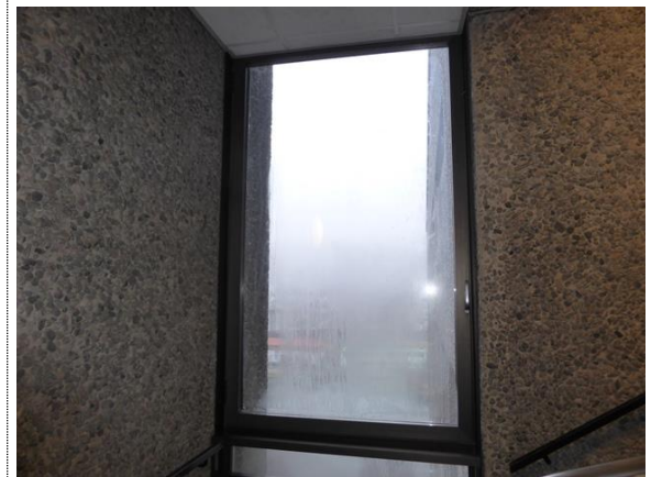
Bilde nr. 2.10 Punktert og utett vindu i trapperom
