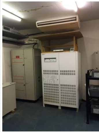
Bilde nr. 4.21 UPS og hovedfordeling USP 400V. Fancoil rett over UPS.
