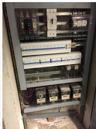
Bilde nr. 4.03 Delvis ombygd underfordeling
