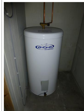
Bilde nr. 3.10 Varmtvannsbereder på 200 liter
