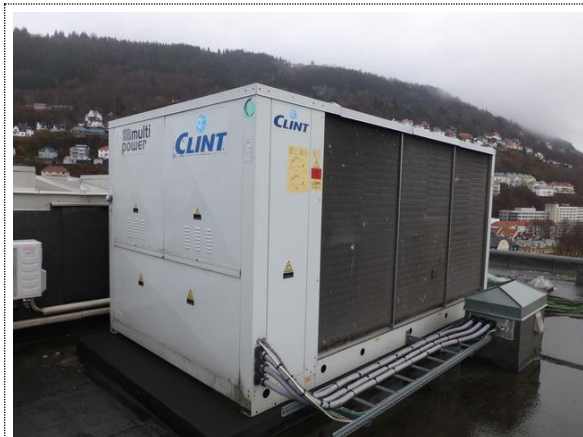
Bilde nr. 3.26 Chiller på tak
