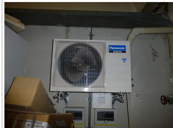
Bilde nr. 3.20 Utedel til fancoil plassert i teknisk rom
