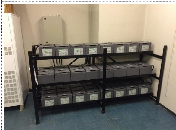
Bilde nr. 4.20 Batteribank for UPS
