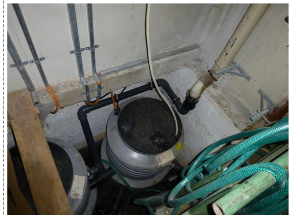
Bilde nr. 3.02 Spillvannspumper
