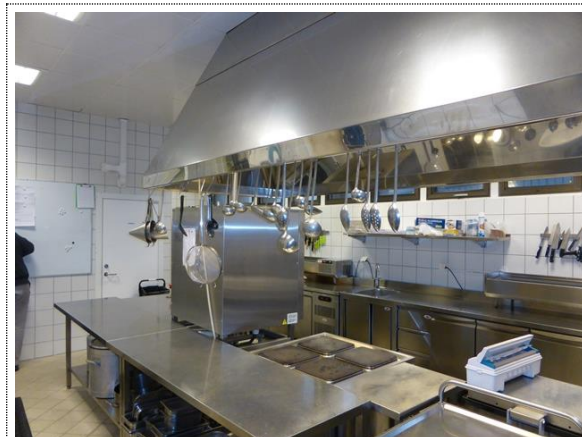
Bilde nr. 6.02 Innredning storkjøkken
