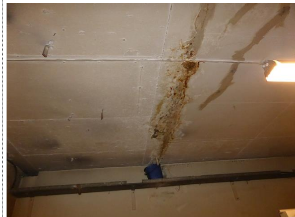
Bilde nr. 2.16 Lekkasje i himling i rom K16 i underetasje
