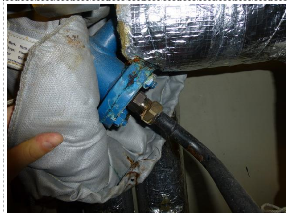
Bilde nr. 3.08 Lekkasje i filterkobling
