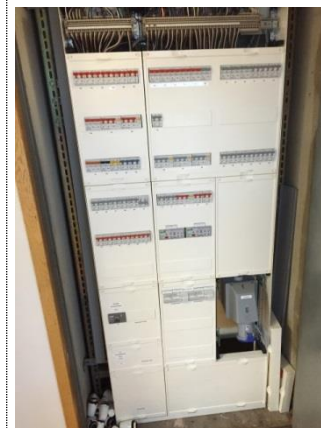
Bilde nr. 4.04 Ombygd underfordeling
