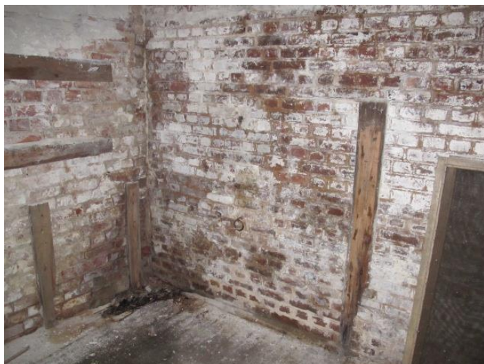
Fig 20 Fuktproblemer bakvegg, bygg I.
