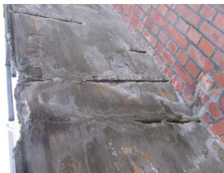
Fig. 45 armeringkorrosjon underside balkong.
