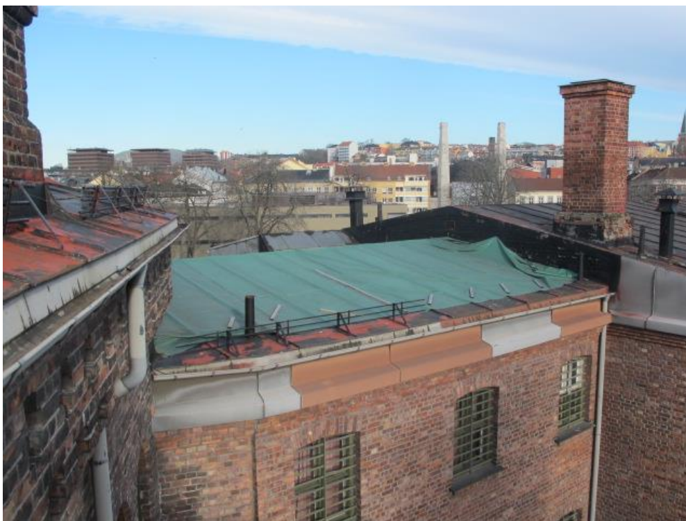
Fig 31 Fløy D, større lekkasje sikret med presenning.
