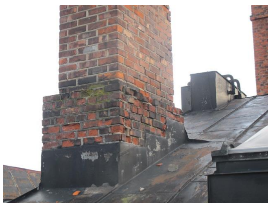
Fig. 41 Skader i murverk pipe
