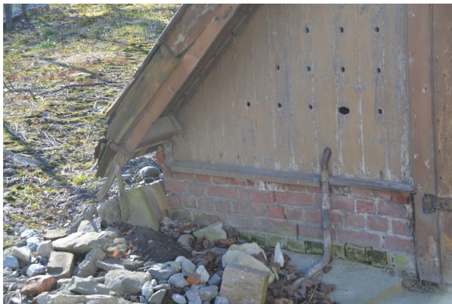
Fig 29 Bygg K, råteskadet treverk, sprekker og forvitring av teglstein.
