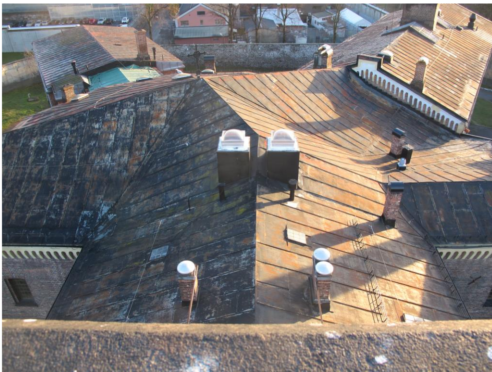
Fig 30 Eksisterende skivetekking – korrosjonsskadet.
