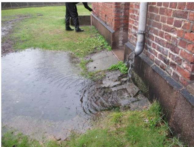
Fig 18 Vann stående langs yttervegg.
