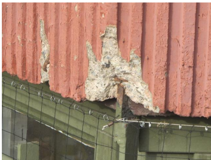
Fig 26 Fløy M, skader i betongfasade.
