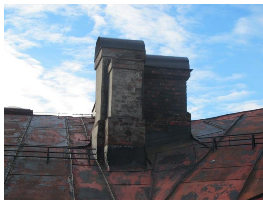
Fig 42 Forvitrede og utvaskede fuger
