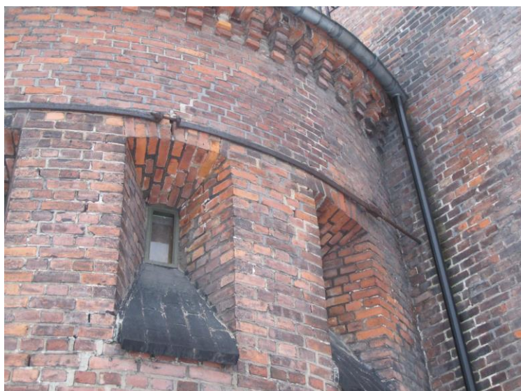
Fig 25 Fløy B, sprekk i murvegg
