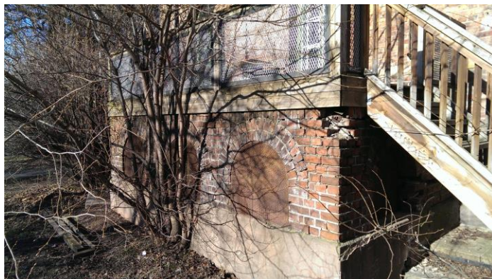
Fig 27 Bygg G, oppsprukket murverk
