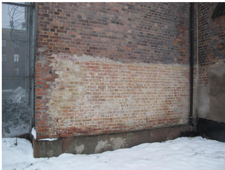
Fig 24 Fløy C, sprekk i murvegg
