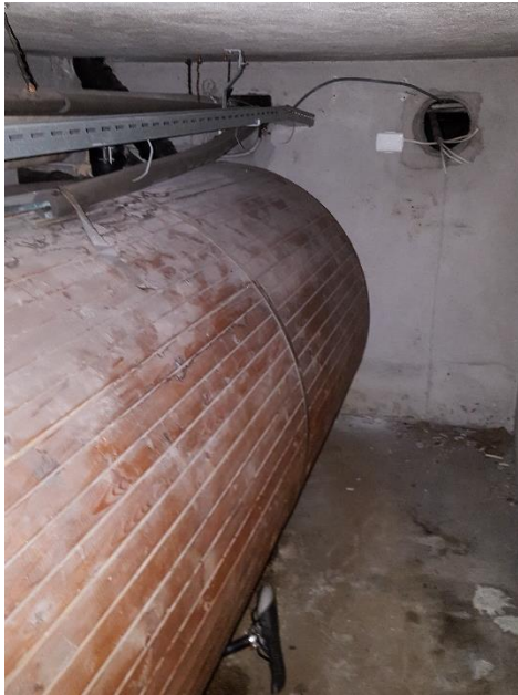
Bilde 9: Varmtvannsbereder som kan ha asbestholdig isolasjon, kjeller.
