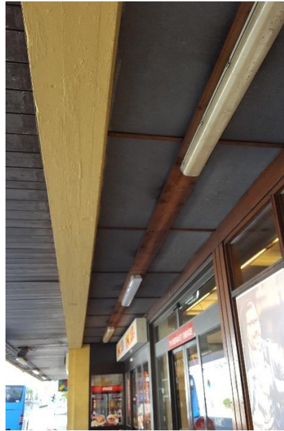
Bilde 10: Eternittplater i tak over inngangsparti mot Vestre Strandgate.
