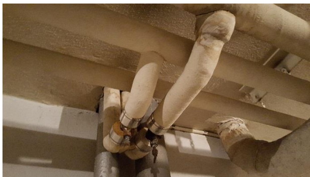
Bilde 5: Rør med hvitmalt strie.
