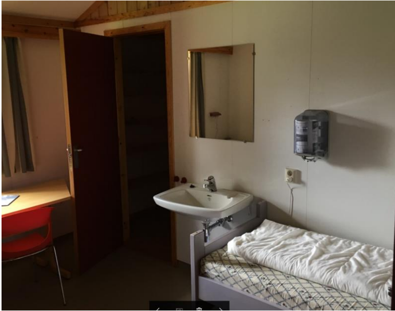
3. Soverom nr 9. Bildet viser også dør som skal tettes og ny inngang til nærliggende bad skal utføres.
