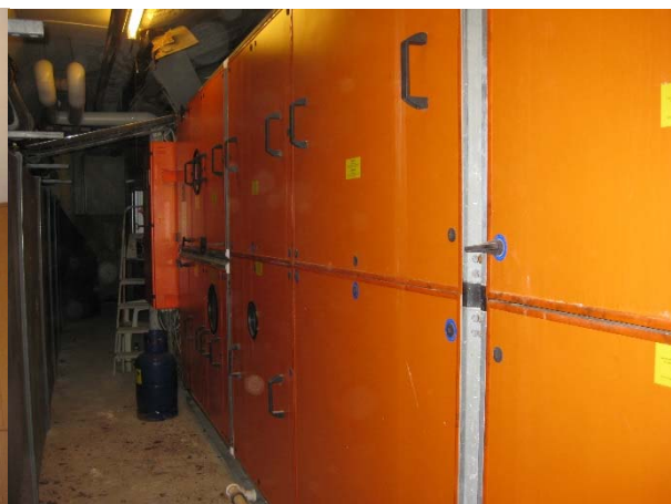
Bilde 36: Ventilasjon svømmehall. Punkt 365.2 Menerga
