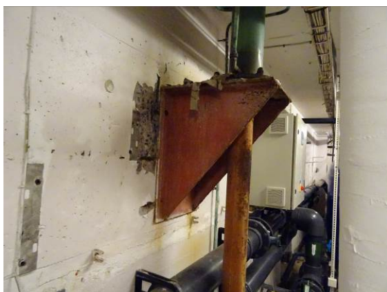
Foto nr. 55 Store rustskader på fundament og forankringer for handicap heis.
