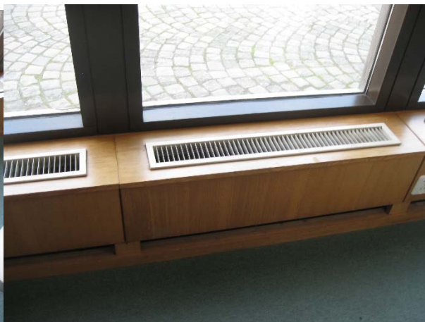
Bilde 24: Konvektorer i kantine
