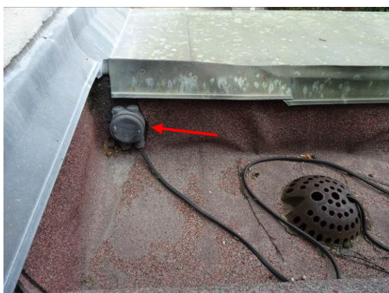
Foto nr. 20 Koblinger i forbindelse med varmekabler er svake punkt med hensyn til lekkasjer rundt disse.
