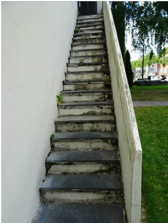
Foto nr. 9 Skiferstein ligger løst, samt løs og skadet betong i opptrinn.
