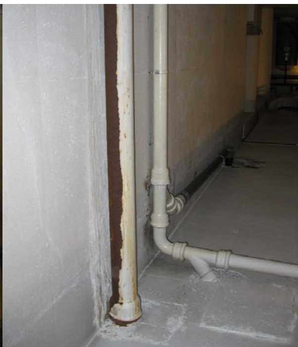
Bilde 8: Nedløp fra garderobes til svømmehallen.
