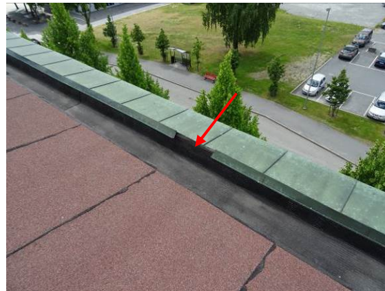
Foto nr. 28 Løsnet beslag mot vest.
