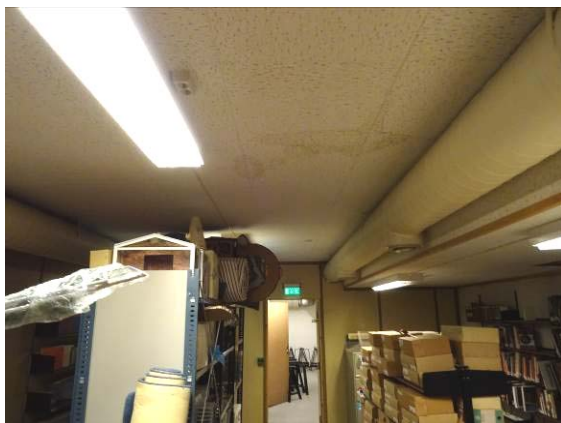
Foto nr. 37 Himling med lekkasjeskader i kjeller.
