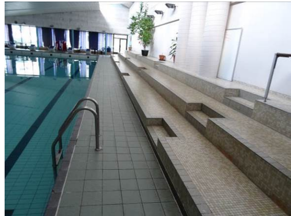
Foto nr. 4 Tribune i svømmehall. Store betongskader underkant betongdekket, se foto 2, 3.
