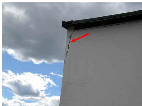
Foto nr. 17 Stor betongskade i hjørne av hovedbygg mot sørøst.
