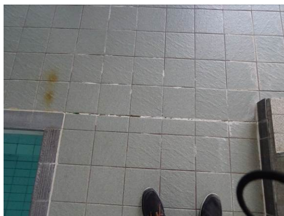
Foto nr. 58 Løse og manglende mørtelfuger. Saltutslag i fuger.
