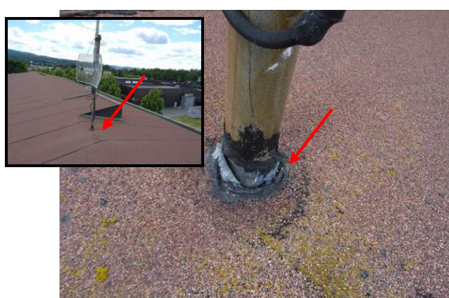
Foto nr. 29 Lekkasjepunkt ved oppstikk på yttertak mot vest.
