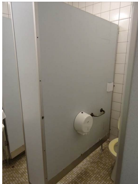
Foto nr. 50 Toalettvegger med stor slitasje.
