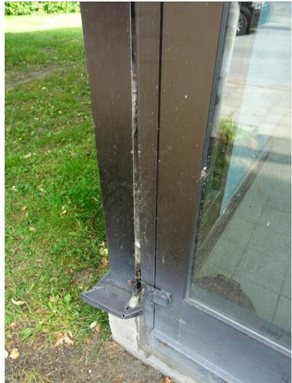
Foto nr. 10 Skader, eksponert isolasjon i utvendig hjørne på svømmehall.
