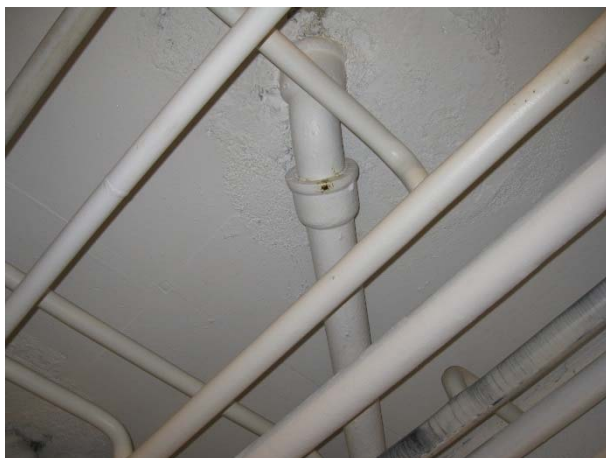
Bilde 1: Avløpsrør i kjeller under svømmehall
