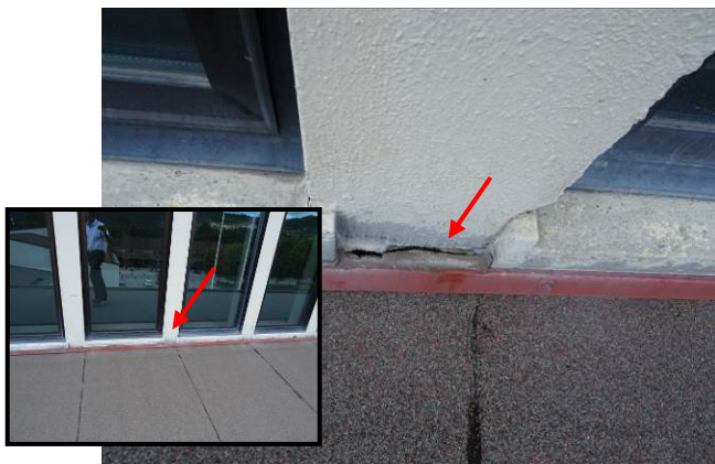
Foto nr. 24 Åpent ved vegg, lekkasjepunkter.
