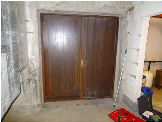
Foto nr. 7 Innside av dør på foto nr. 7, mye rust.
