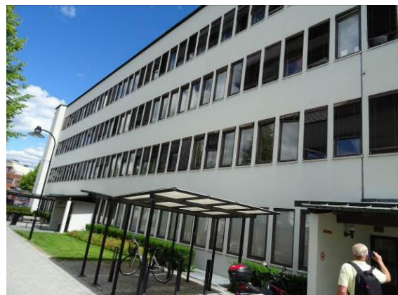
Foto nr. 6 Vinduer som anbefales skiftet ut.
