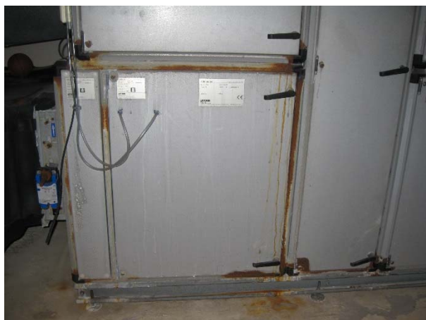
Bilde 37: Aggregat VA-4. Garderobesvømmehall
