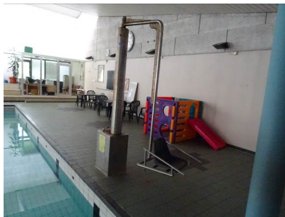
Foto nr. 56 Handicap heis med store rustskader.
