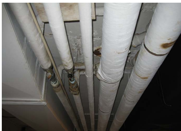
Figur 5: Rørføringer i kjeller under svømmehall
