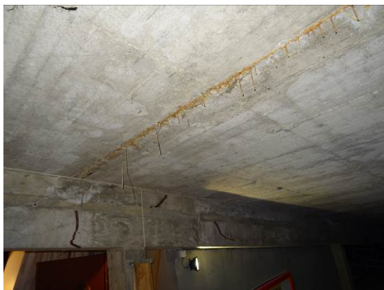
Foto nr. 53 Vann/fukt gjennomtrengning i dekke under forlass/inngangsparti.
