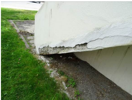
Foto nr. 8 Store betongskader på sidevange/trinn.
