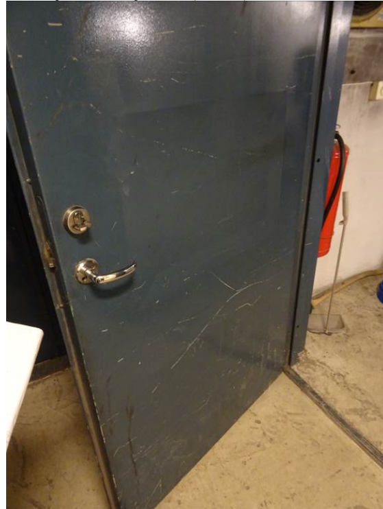
Foto nr. 41 Tilsmusset og malingsslitt ståldør i kjeller til pumperom.
