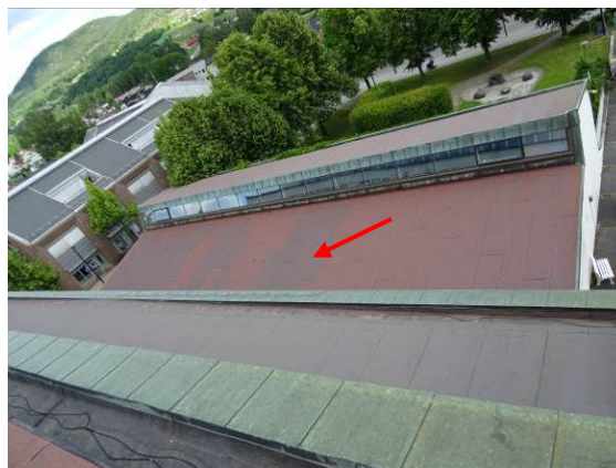
Foto nr. 21 Oversikt av tekket tak over svømmehall, samt vinduer som ikke er skiftet siden byggeår. Lappinger etter noen omtekninger på taket.
