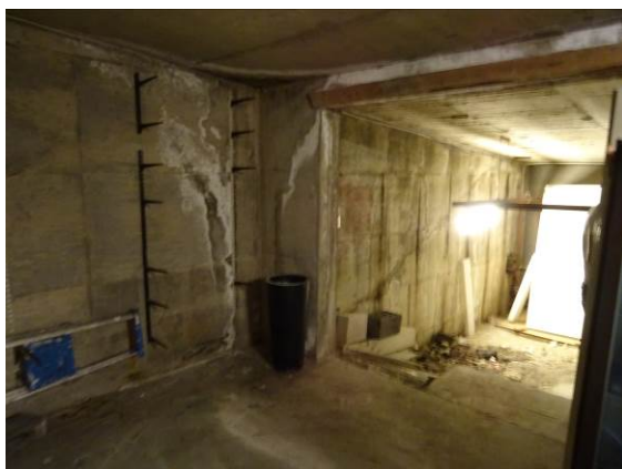
Foto nr. 54 Betongskader på vegger under forlass/inngangsparti.
