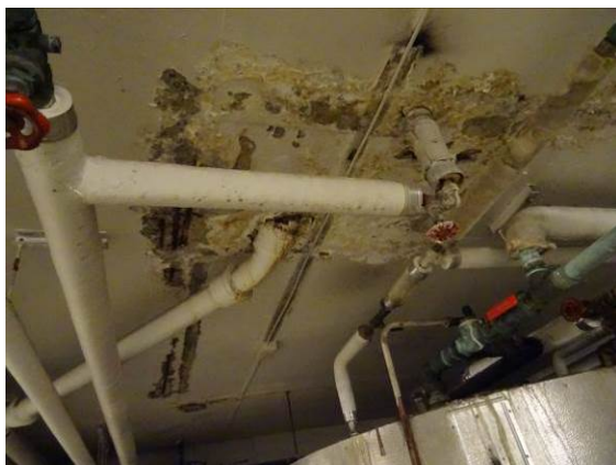
Foto nr. 42 Store skader i betongdekke i forbindelse med rørgjennomføring fra svømmehall.
