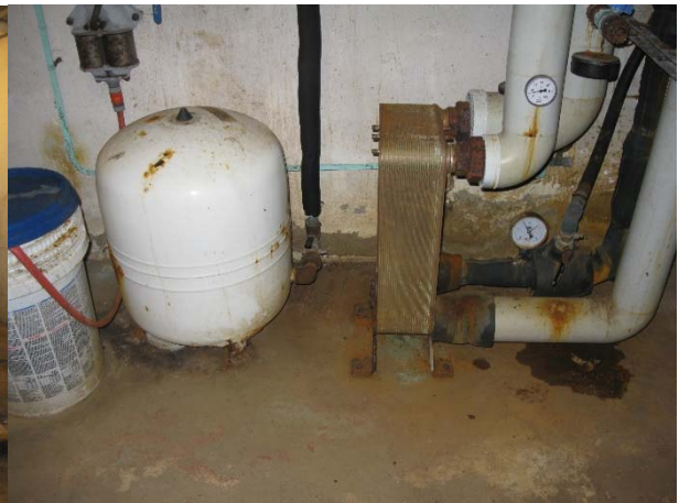
Bilde 21: Eksansjonskar og veksler til snøsmelleanlegg
