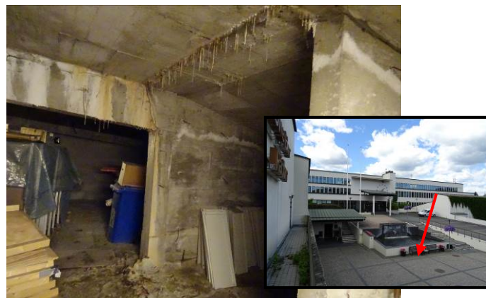
Foto nr. 52 Vann/fukt gjennomgang i dekke og vegg
