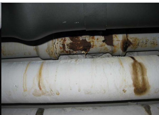
Bilde 6: Rørføringer i kjeller under svømmehall
