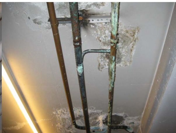
Bilde 2: Rørføringer ved varmtvannsberedere i kjeller
