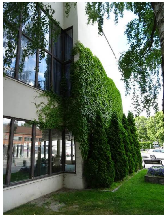
Foto nr. 11 Busker vokser tett inn på vegg og vinduer. Dette er ikke tilfredsstillende/uheldig med hensyn til vedlikehold av vegger og skader på vinduer.
