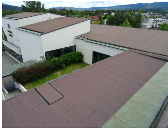
Foto nr. 22 Oversikt tak over hovedinngang. Flere lappinger på papptekkingen.
