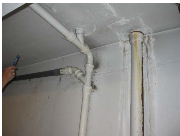
Bilde 9: Nedløp fra garderobes til svømmehallen
