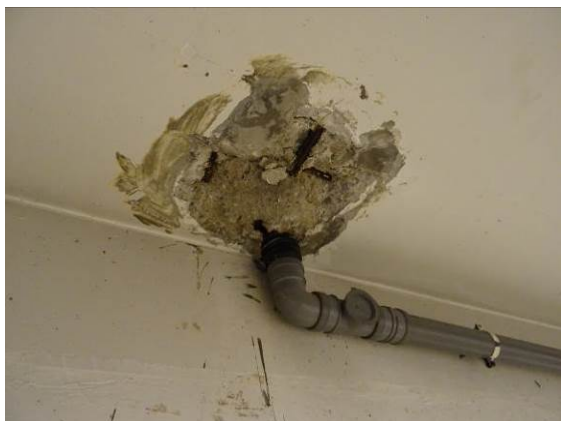
Foto nr. 43 Skader rundt rørgjennomføring.
