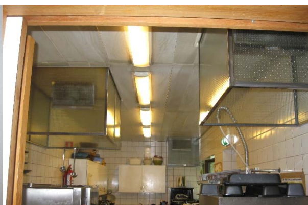
Bilde 28: Avtrekkssetter kantinekjøkken
