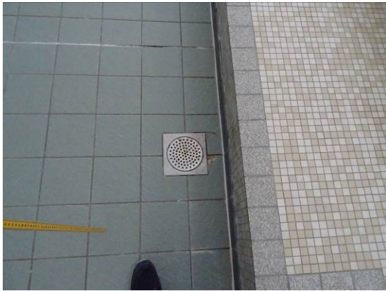
Foto nr. 59 Knuste fliser samt manglende mørtelfuger.
