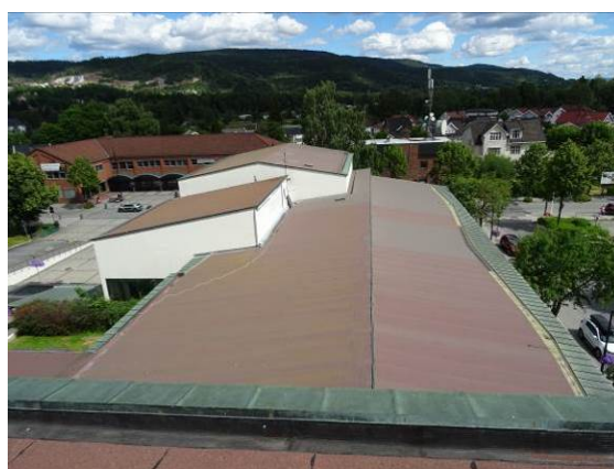
Foto nr. 23 Oversikt av takpapp over lavbygg. Mange lappinger på papptekking.
