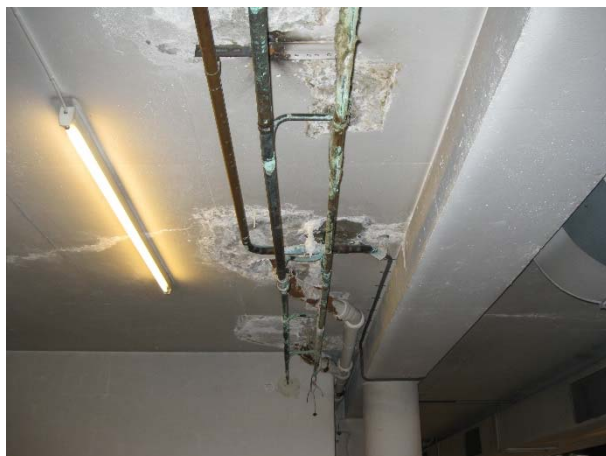
Bilde 3: Rørføringer ved varmtvannsberedere i kjeller
