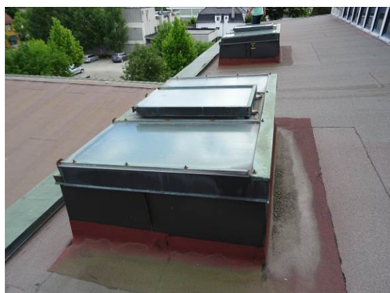
Foto nr. 25 Overlys med flere knuste glass. Dårlige/svake detaljløsninger på overlys- oppbyggene.
