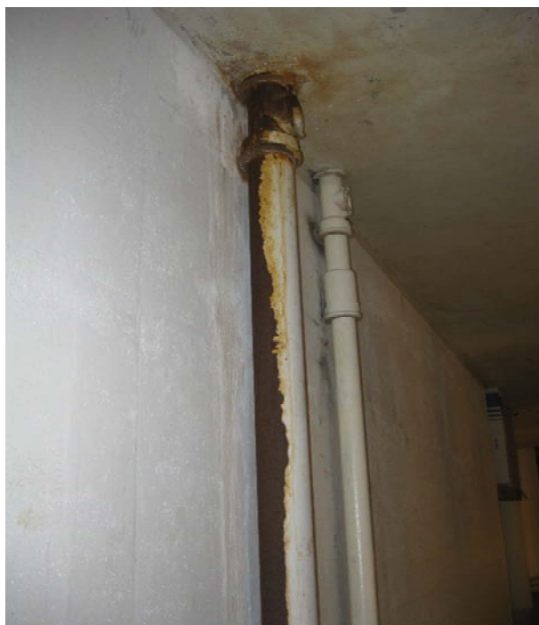
Bilde 7: Nedløp fra garderobes til svømmehallen.
