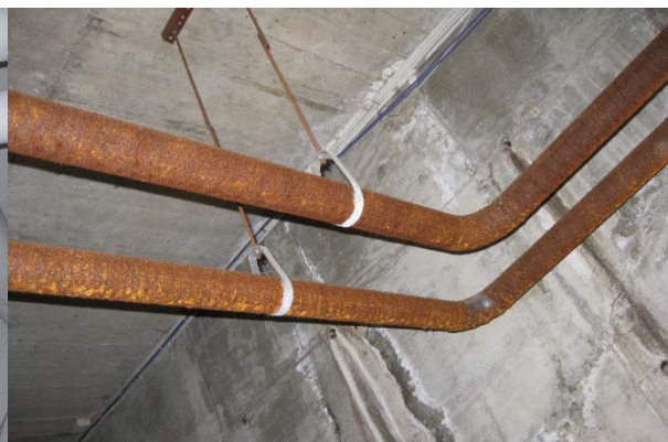
Bilde 17: Varmørør til snøsmelleanlegg
