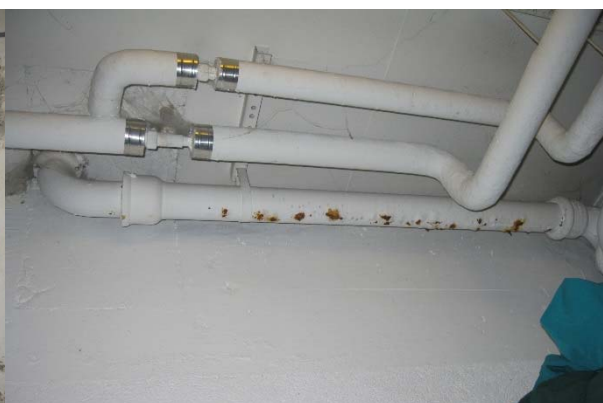
Bilde 12: Rørføringer i skifterom nedenfor kantine.
