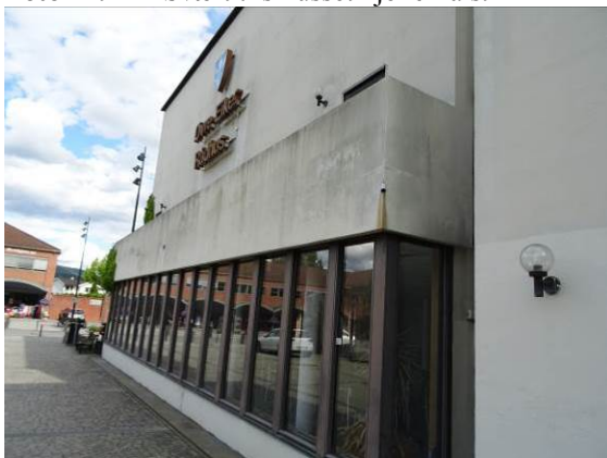
Foto nr. 13 Mosebegroing på yttervegger, spesielt på lesiden av værþåkjenninger.
