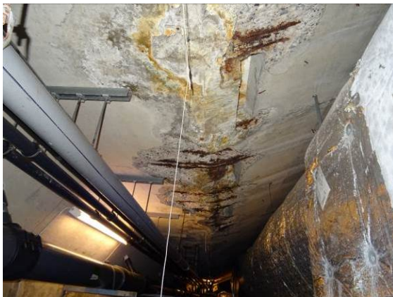
Foto nr. 2 Store skader i underkant dekke ved overliggende tribune i svømmehall.
