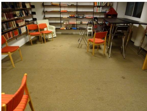
Foto nr. 36 Stor slitasje på teppe i leserom, barnehage og gang i kjeller.
