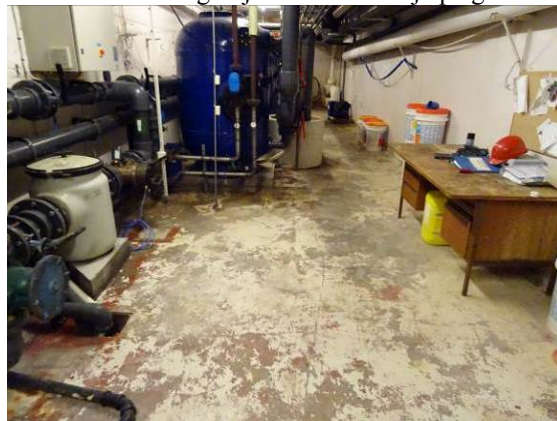
Foto nr. 35 Stor malingslitasje på golv i tekniske rom.
