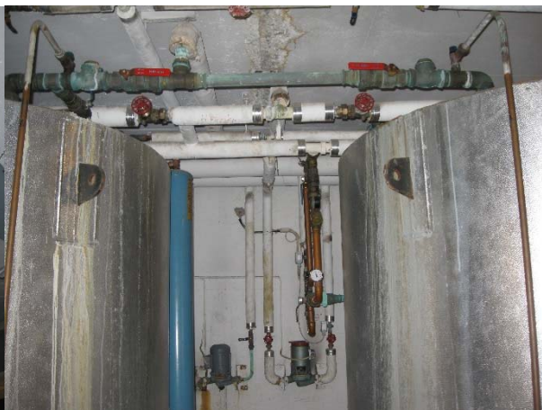
Bilde 4: Rør til varmtvannsberedere. Legionella.
