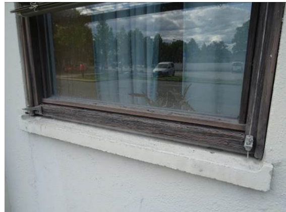
Foto nr. 5 Stor slitasje på trevindu, både pakninger og overflate.
