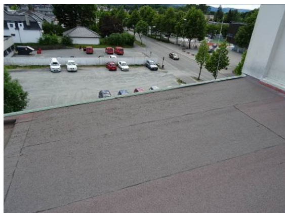
Foto nr. 26 Ingen gesimskant/oppbygning.
