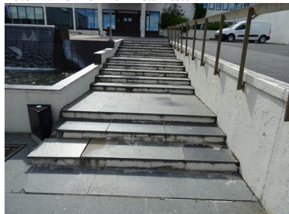
Foto nr. 16 Kalkavleiring og betongavskallinger i opptrinn, samt noe løse mørtelfuger.
