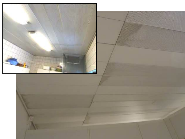
Foto nr. 40 Typisk stålprofilhimling, tilsmusset, løse/skjeve etc. Kjøkken (innfelt)
