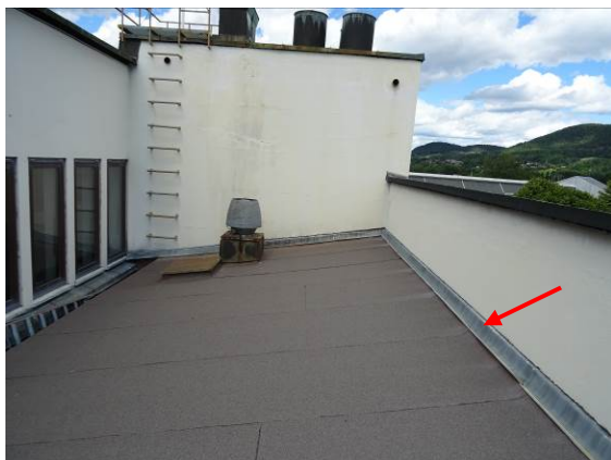
Foto nr. 18 Fuger og beslag ser ut for å være fra byggeår, flere svake punkter med hensyn til mulige lekkasjer.
