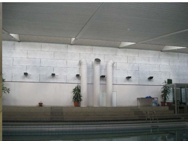
Bilde 30: Avtrekk svømmehall
