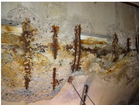
Foto nr. 3 Armering er delvis kappet av etter kloridinfiltrert betong.
