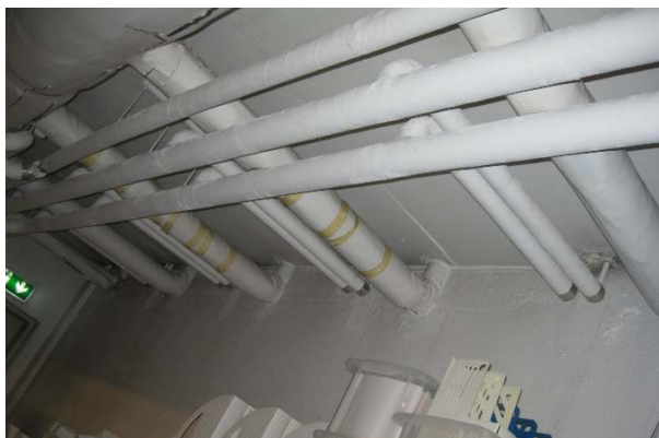
Bilde 16: Varmørør til konvektorer
