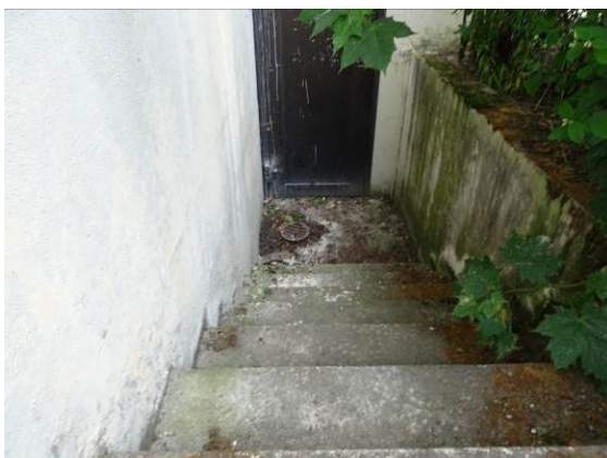
Foto nr. 14 Svært tilsmusset kjellerhals med busker tett innþå trappevange.
