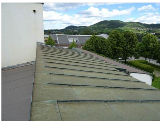
Foto nr. 19 Kobberbeslag ligger godt, men bør sjekkes nærmere om det er behov for en utskifting nærmeste fremtid.
