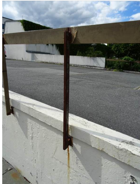
Foto nr. 15 Rekkverk i stål ruster.
