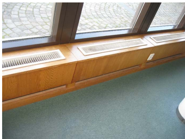
Bilde 23: Konvektorer i kantine
