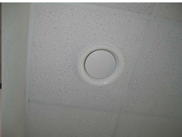
Bilde 26: Avtrekksventil kontor tilhørende VA-13.
