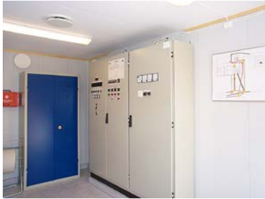
Elektroskap i de nye anlegg.
