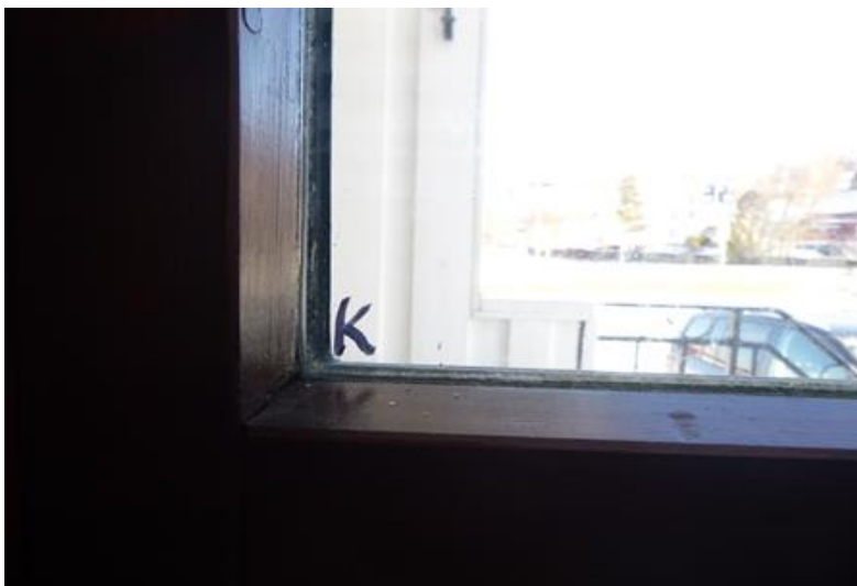
Figur 4: Isolerglassvindu som inneholder klorparafiner, markert med bokstaven «K»
