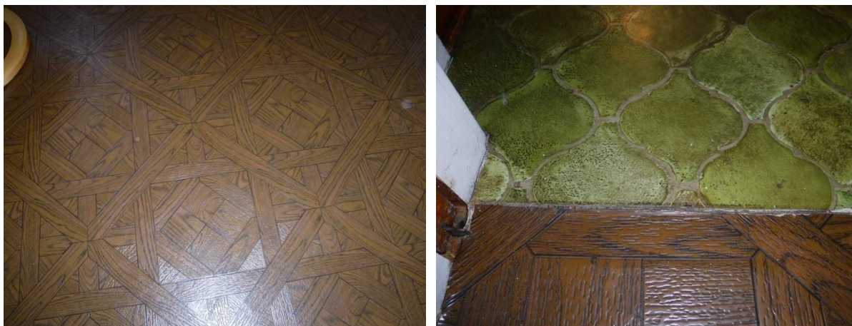
Figur 20: Gulvbelegg på kjøkken og på stue inneholder asbest
