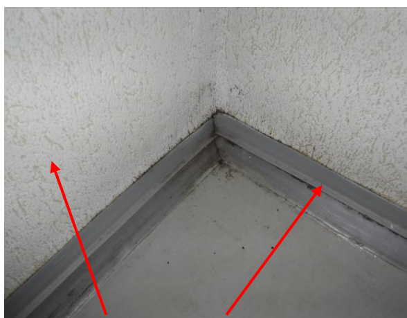
Figur 16: Vinyltapet og vaskelister er farlig avfall
