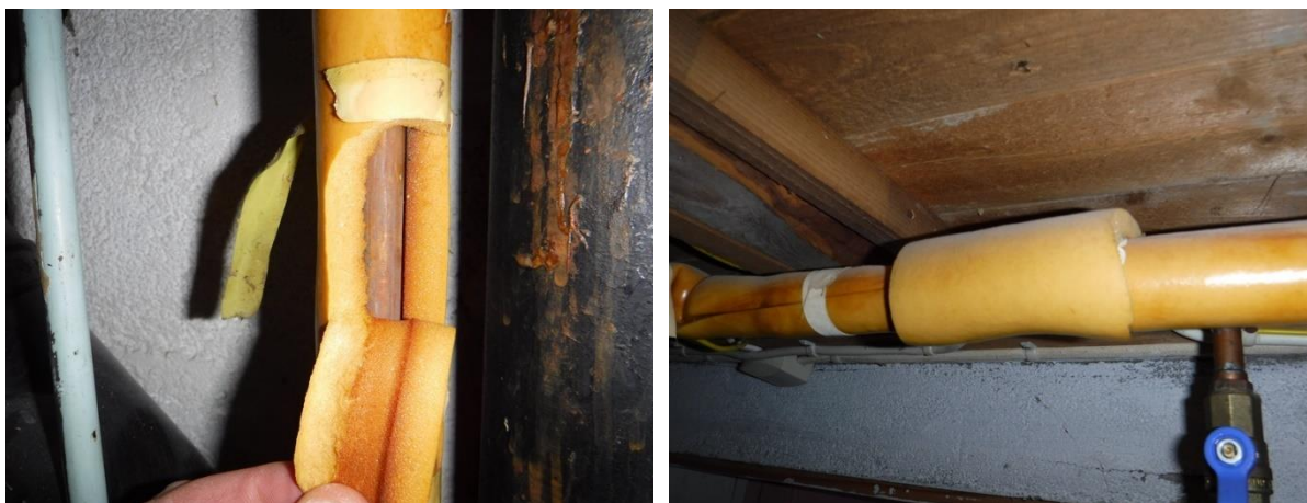
Figur 5: Cellegummiisolasjon i kjeller er farlig avfall
