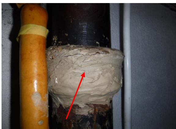
Figur 22: Fyllmasse på soillrør i kjeller
