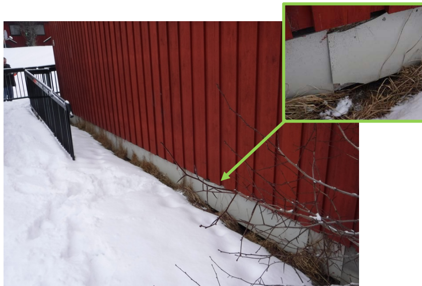
Figur 12: Eternitt på gavl, farlig avfall
