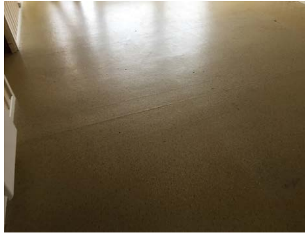
Figur 7: Gulvbelegg i stue, ftalatholdig
