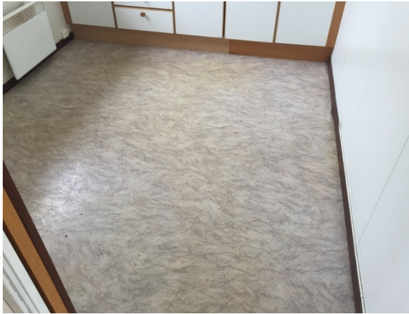
Figur 6: Gulvbelegg på kjøkken, ftalatholdig
