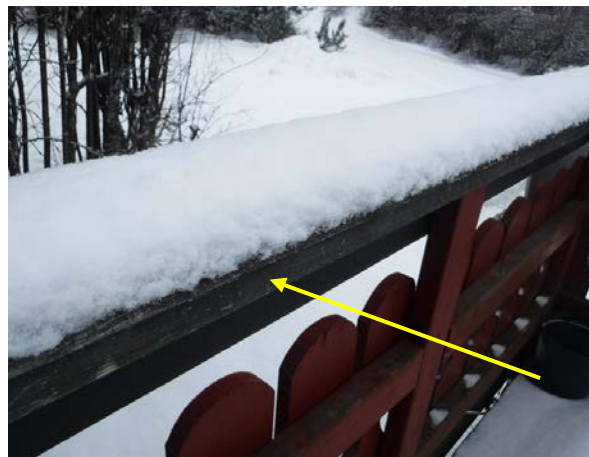
Figur 10: CCA-impregnert rekkverk på veranda
