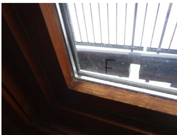
Figur 5: Isolerglass inneholdende ftalater. Merket med "F"
