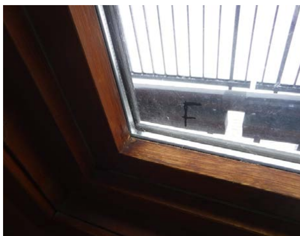
Figur 3: Isolerglass merket med tusj med påskriften "F" for ftalater
