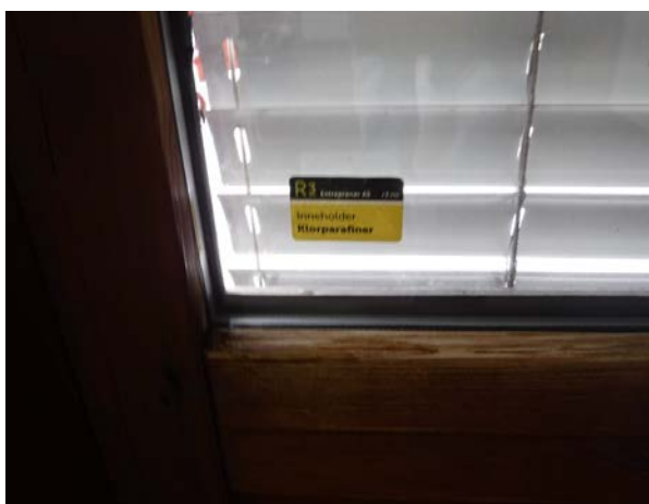
Figur 2: Isolerglass merket med klistremerke "inneholder klorparafiner"
