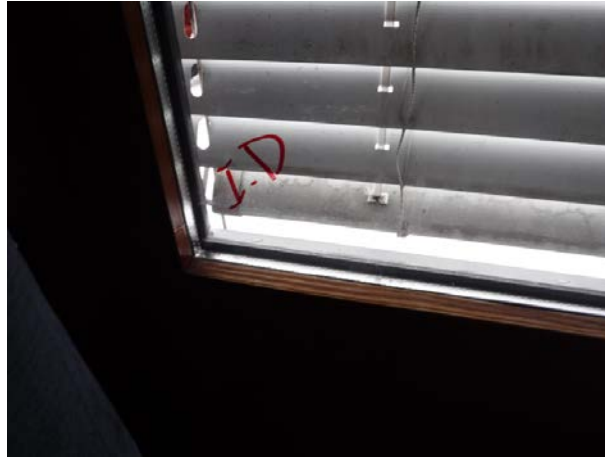
Figur 6: Isolerglassrute merket med tusj og bokstavene "I.D" , isocyanater og dioksiner
