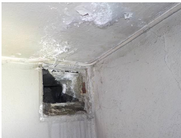
Bilde 11 viser lufteluke på toalett ved trapp ved kortvegg i østfløyen, underetasje. Det er asbestholdig eternitt i luftekanalene.
