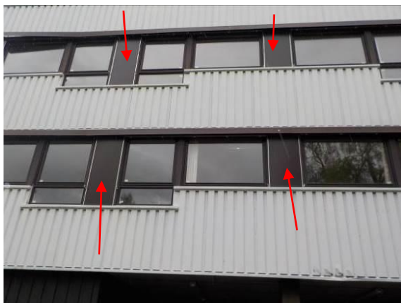
Bilde 23 viser brune asbestplater på fasade på vestfløy.
