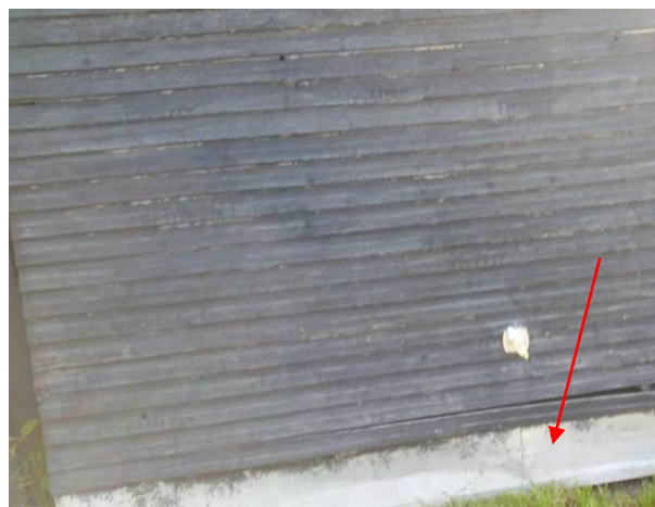
Bilde 27 viser asbestholdige eternittplater på grunnmur på frittstående garasje.
