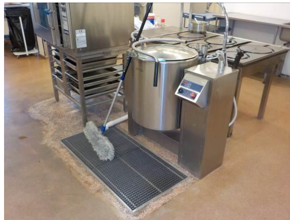
Bilde 73 viser epoxybelegg over terrazzo på kjøkken i underetasje, vestfløy. Epoxy er forurenset med PCB.
