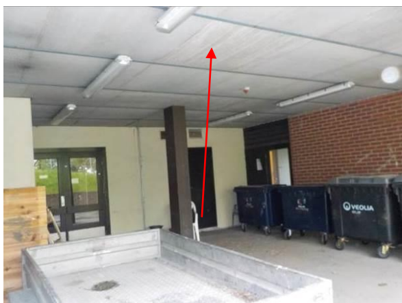
Bilde 24 viser asbestholdige eternittplater i tak på overbygg mellom garasje og trafo i vestfløy.
