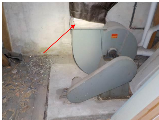
Bilde 16 viser ventilasjonsvifte på loft i østfløy. Filtmaterialet på viften kan inneholde asbest. Viften leveres som EE-avfall, og mottaker av EE-avfallet sorterer ut eventuelle asbestholdige komponenter.
