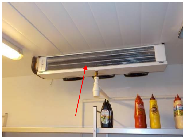
Bilde 53 viser kjøleanlegg i kjølerom i kjøkken, underetasje, vestfløy.
