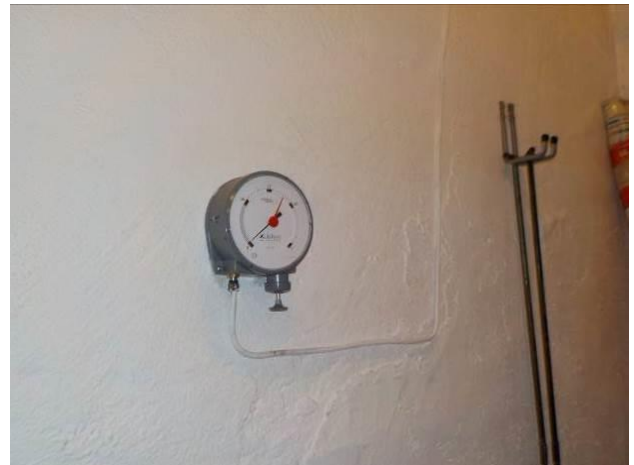
Bilde 76 viser oljemåler som ble observert i fyrrom i kjeller i østfløy.
