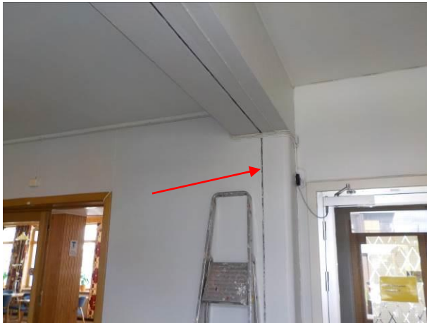
Bilde 59 viser fugemasse mellom betongelementer i gang ved inngangsdør på midten av østfløy, underetasje. Fugemassen håndteres som farlig avfall med PCB.
