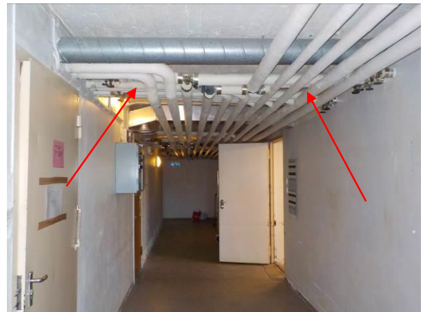
Bilde 2 viser eldre asbestholdig rørisolasjon i kjelleretasje i østfløy. Det er et rosa pulver i både rørbend og enkelte rørstrekk som er asbestholdig.
