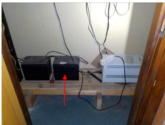
Bilde 37 viser batterier og kabler som eksempel på EE-avfall.
