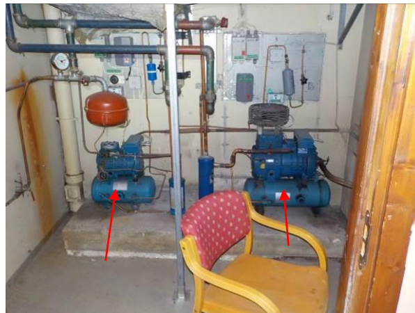
Bilde 52 viser to kjøleaggregat fra 1992 i ventilasjonsrom bak kjøkken i underetasje, vestfløy.
