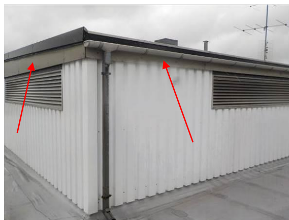
Bilde 22 viser asbestholdige plater på fasade på ventilasjonsloft på vestfløy.
