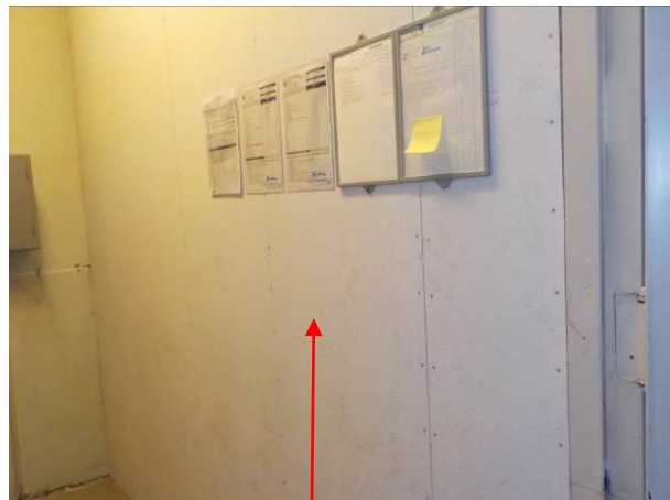
Bilde 7 viser asbestholdige plater på vegg i El-tavlerom i underetasje i østfløy.
