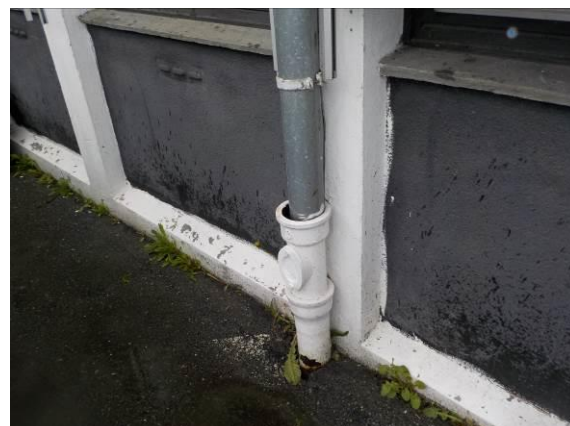
Bilde 31 viser nedløpsrør med bly i skjøten mellom rørdelene, som ble observert på fasaden på østfløyen.
