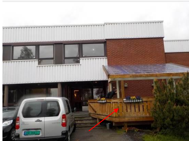
Bilde 35 viser terrasse utenfor inngang til legekontor, som er oppført med CCA-impregnert trevirke.
