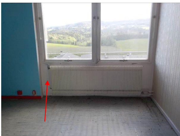
Bilde 15 viser asbestholdige plater under vinduer på hybel i 3. etasje, østfløy.
