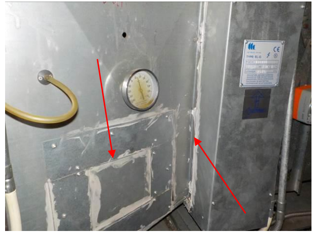
Bilde 60 viser myk fugemasse som ble observert på ventilasjonsanlegg på loft i vestfløy. Fugemassen håndteres som farlig avfall med PCB.
