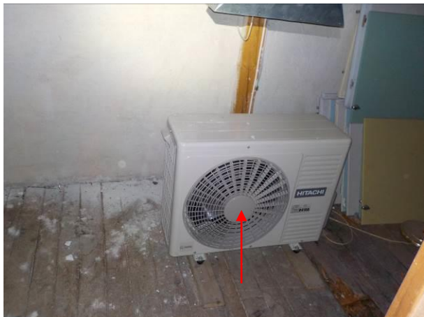
Bilde 50 viser kjøleanlegg som ble observert på loft over 3. etasje i østfløy.
