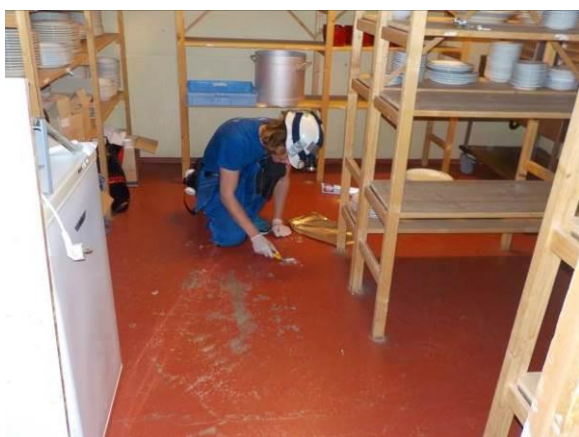
Bilde 65 viser prøvetaking av rødmaling på gulv i underetasje, vestfløy. Rødmalingen er forurenset med PCB og tungmetaller. Beigemaling på vegger ble også prøvetatt. Beigemaling er også forurenset med PCB og tungmetaller.
