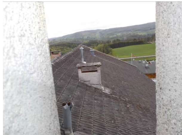
Bilde 30 viser mulig blybeslag rundt både fyringspiper og luftepiper på tak på østfløy.
