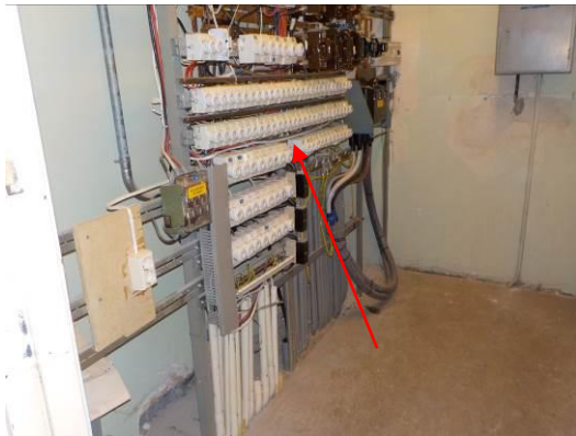
Bilde 36 viser EL-tavle som eksempel på EE-avfall.
