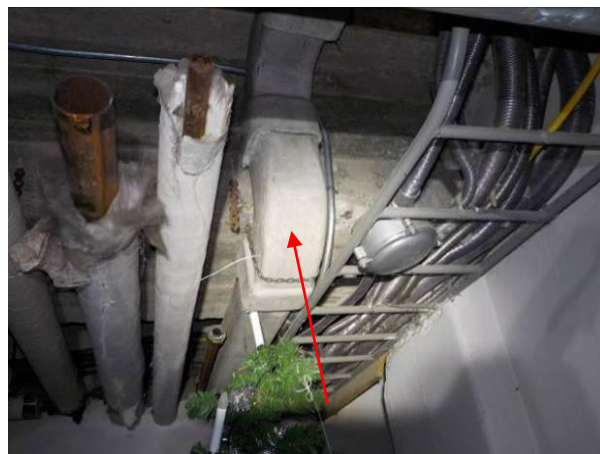
Bilde 6 viser asbestholdig eternittkanal som ble observert i rom for urent tøy i kjeller i østfløy.
