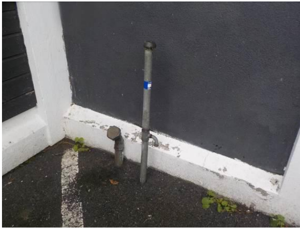
Bilde 77 viser oljepåfyllingsrør som ble observert utenfor fyrrom.
