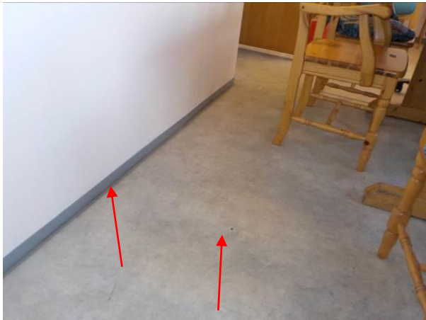
Bilde 40 viser vinylbelegg og vinylister (vaskelister) på gulv i strykerom i kjeller i østfløy.
