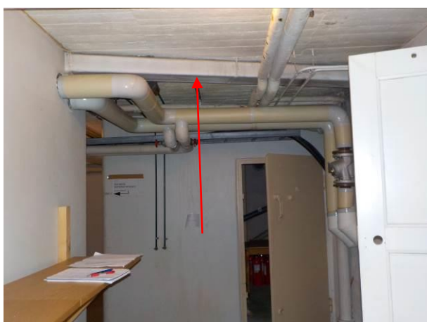
Bilde 5 viser asbestholdig eternittkanal i gang utenfor rom for urent tøy i kjeller i østfløy.
