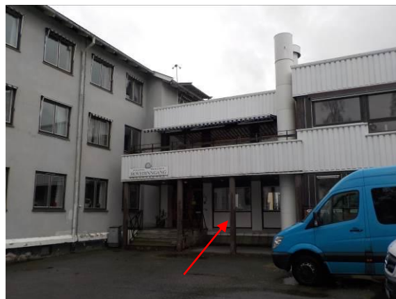
Bilde 26 viser hovedinngang til vestfløy. Det er asbestplater over og under vinduer og dør i inngangspartiet.
