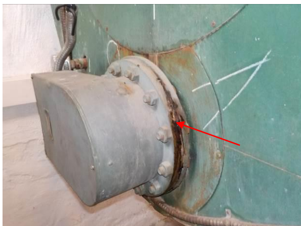
Bilde 4 viser asbestholdig pakning i flense som ble observert i fyrrom i kjeller i østfløy.
