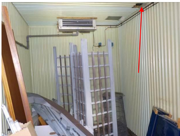
Bilde 18 viser søppelrom i underetasje i vestfløy. Det er en asbestholdig eternittkanal over stålplatene i taket.
