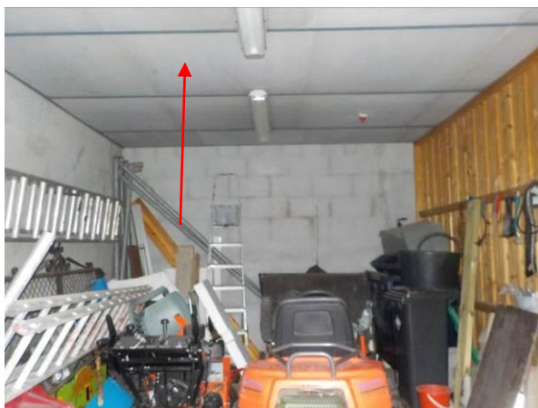
Bilde 19 viser asbestholdige eternittplater i tak i garasje i underetasje, vestfløy.
