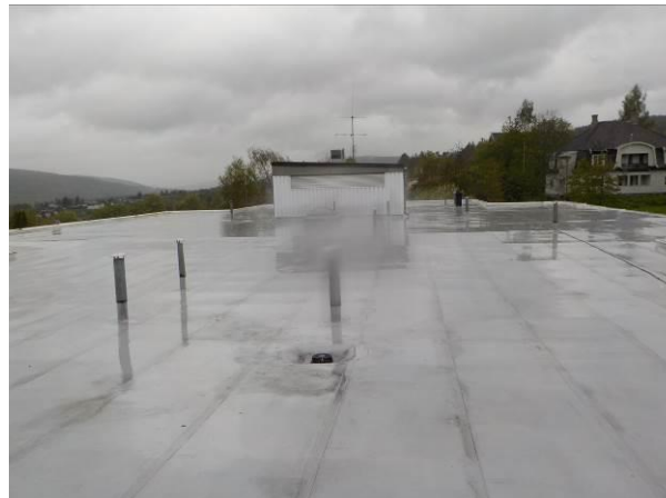
Bilde 47 viser takfolie på tak på vestfløy. Takfolien skal håndteres som farlig avfall med ftalater.
