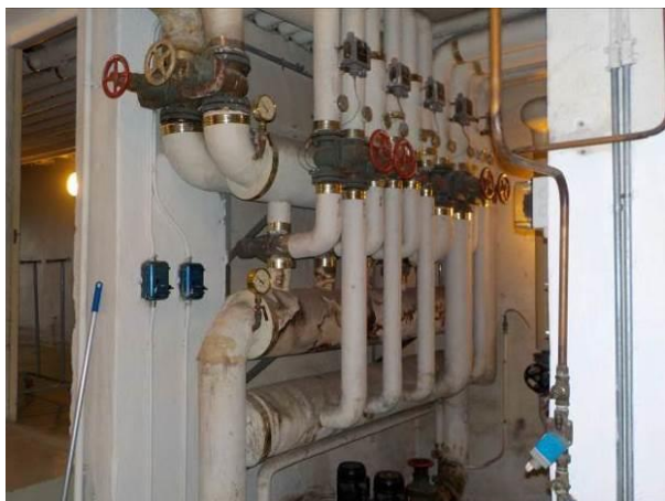
Bilde 3 viser asbestholdig rørisolasjon i fyrrom.
