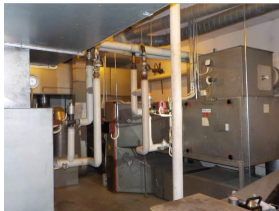
Bilde 21 viser ventilasjonsrom på loft på vestfløy. Det er asbestholdige plater på vegg og tak i dette rommet.
