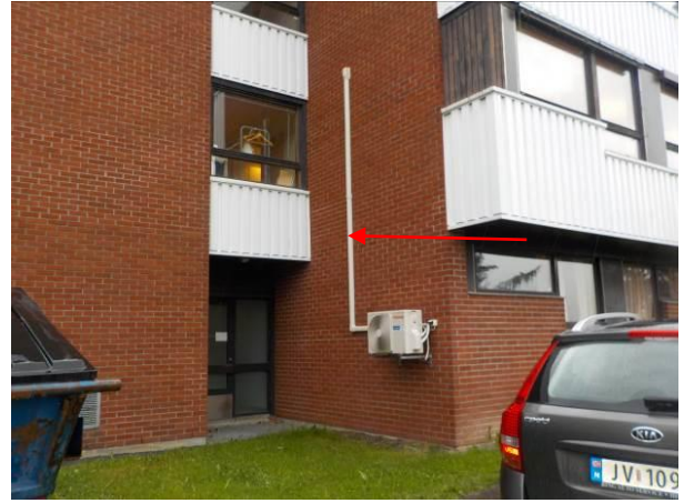
Bilde 33 viser cellegummi som rørisolasjon rundt rør koblet til kjøleanleggets utedel på fasaden på vestfløy.
