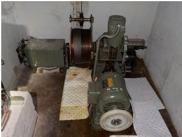
Bilde 78 viser oljeforurenset betong på gulv under heismaskin som står i rom bak kjøkken i underetasje, vestfløy.
