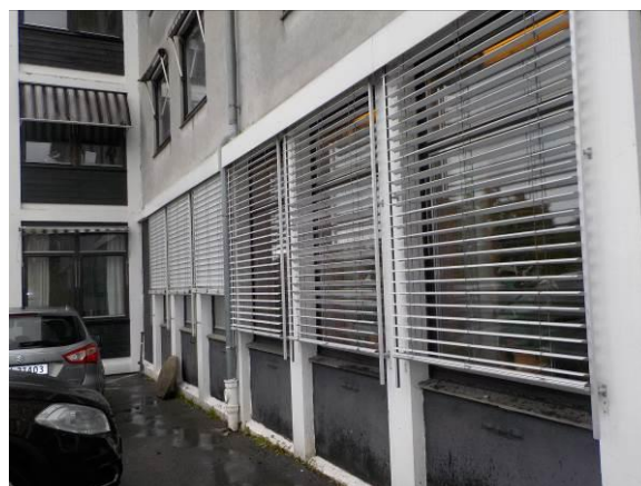
Bilde 68 viser mørk gråmaling på grunnmur på østfløy. Mørk gråmaling er forurenset med PCB.
