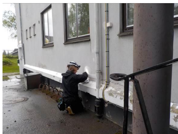
Bilde 67 viser prøvetaking av lys gråmaling på fasade på østfløy. Lys gråmaling er ikke forurenset med PCB eller tungmetaller.
