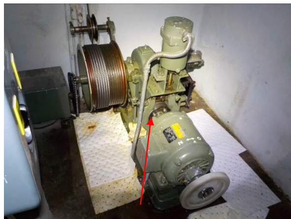
Bilde 17 viser heismaskin i heismaskinrom bak kjøkken i underetasje, vestfløy. Det antas at heismaskinen har asbestholdig bremsebelegg.
