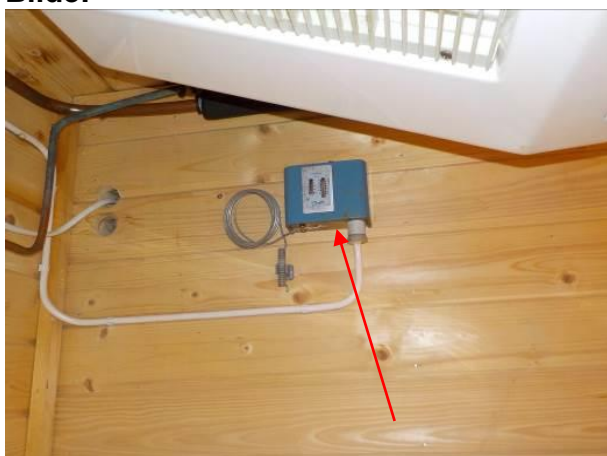
Bilde 58 viser eldre termometer i kjølerom som inneholder kvikksølv. Slike elektriske termometre leveres som EE-avfall.
