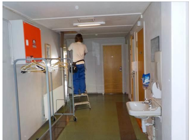
Bilde 63 viser hvitmaling i gang i underetasje, østfløy. Hvitmalingen er forurenset med PCB og tungmetaller.
