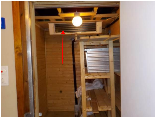
Bilde 54 viser eldre kjøleanlegg i eldre kjølerom i hovedgang i underetasje, vestfløy.
