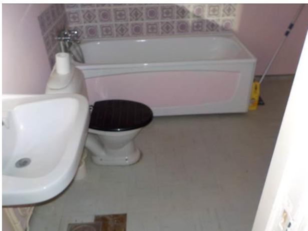
Bilde 14 viser grå vinylfliser på gulv på bad i hybel i 3. etasje, østfløy. Flisene inneholder ikke asbest, men skal håndteres som farlig avfall med ftalater, se kap. 3.6.
