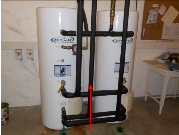
Bilde 32 viser cellegummi som rørisolasjon observert i fyrrom i kjeller i østfløy. Cellegummi skal håndteres som farlig avfall med bromerte flammehemmere.
