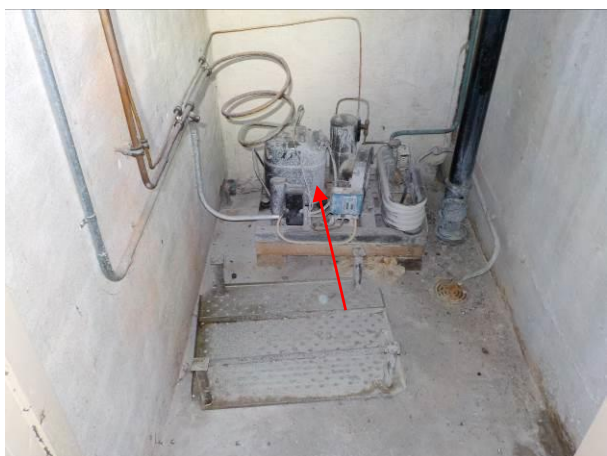
Bilde 51 viser eldre kjøleanlegg bak kjøkken i underetasje, vestfløy.
