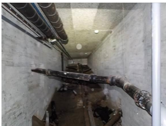
Bilde 29 viser soilrør med bly i skjøten mellom rørdelene, som ble observert i kulvert i kjeller i østfløy.
