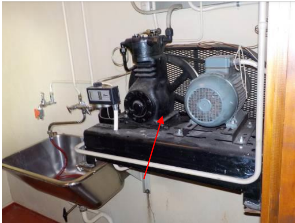
Bilde 55 viser kjøleanlegg i lite rom ved berederrom i underetasje, vestfløy.
