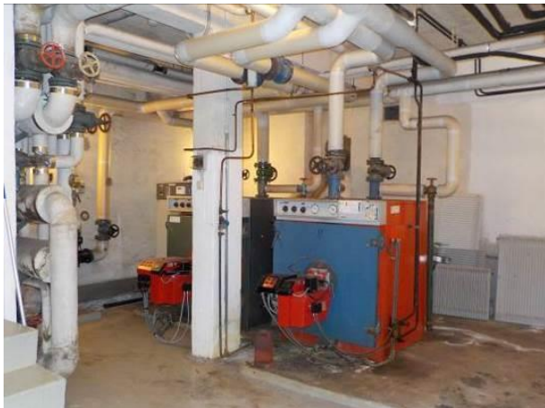
Bilde 75 viser to oljefyr, og én el-fyr i fyrrom i kjeller i østfløy.
