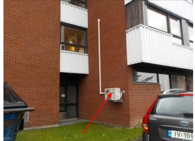
Bilde 57 viser kjøleanleggets utedel som ble observert på fasaden på vestfløy.
