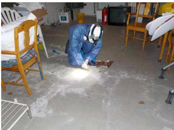
Bilde 62 viser prøvetaking av gråmaling på gulv i tørkerom, kjeller i østfløy. Gråmalingen er forurenset med PCB og tungmetaller.
