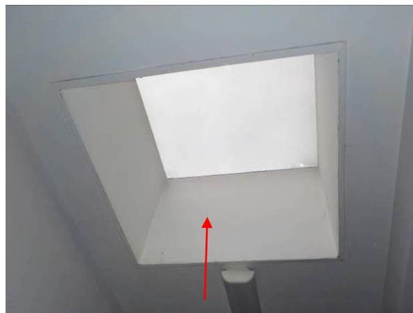
Bilde 20 viser overlys i 2. etasje, vestfløy. Erfaringsmessig kan platene på innsiden av lyskanalen bestå av asbestplater. Disse platene ble sjekket, og består i dette tilfellet av trefiberplater som kan leveres som ordinært avfall.
