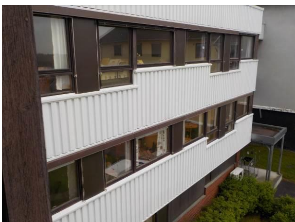
Bilde 86 viser stålplater på fasade på vestfløy. Det ble observert sort vindtettingspapp bak stålplatene på balkong. Pappen kan håndteres som ordinært avfall.
