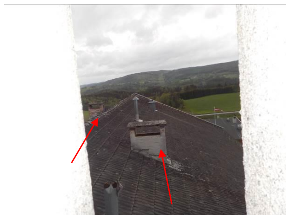
Bilde 81 viser to fyringspiper på tak på gul del av østfløy.
