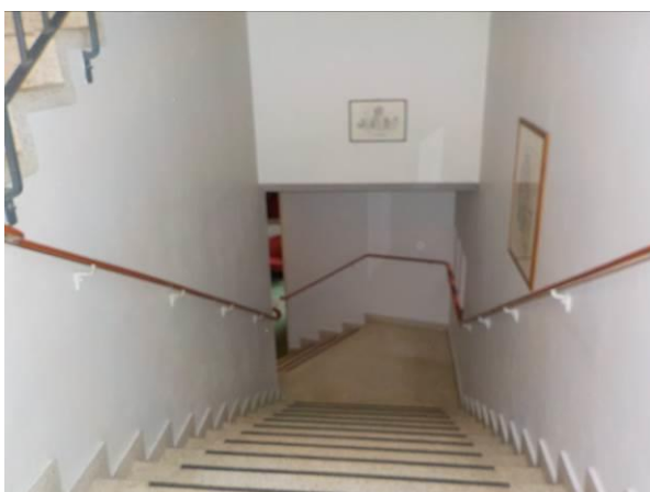
Bilde 72 viser lys terrazzo fra hovedtrapp. Terrazzo er ikke forurenset med PCB eller tungmetaller.
