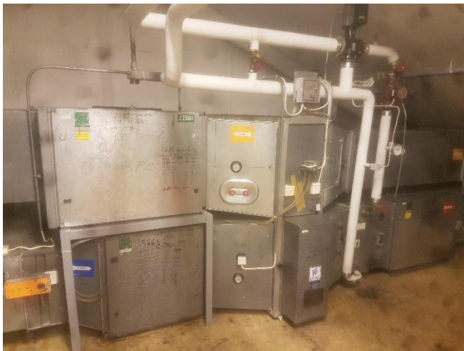
Bilde over – teknisk rom nordfløy: Aggregat som betjener sørfløyen skal rives
