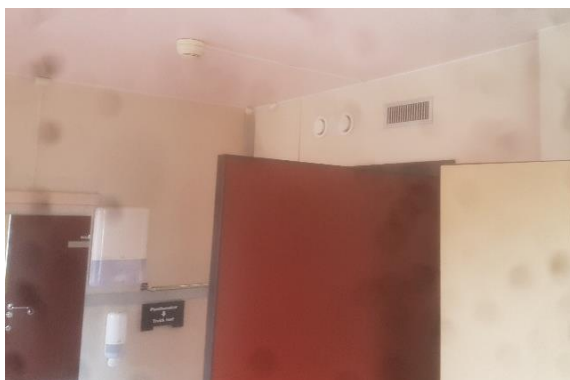
Bilder over: Sørfløya – tilluft og avtrekk sykerom
