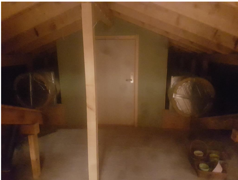
Bilde over: Kanaler fra aggregatet i øst, for forberedt for innkobling mot sør (ø630)
