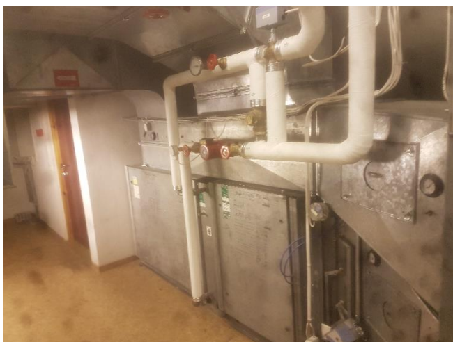
Bilder over – teknisk rom nordfløy: Aggregatet som betjener nordfløyen skal rives.
