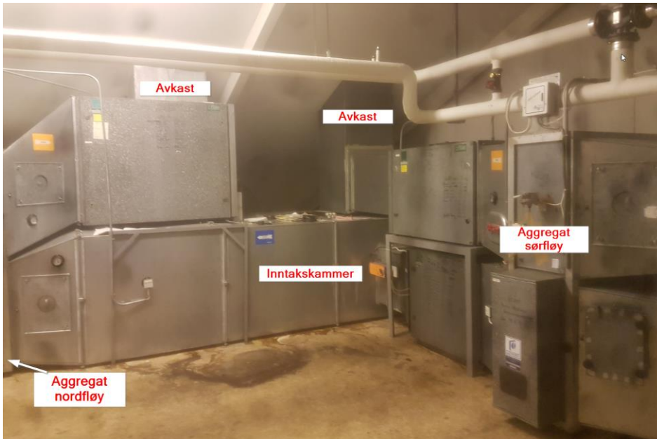
Bilder over – teknisk rom nordfløy: Orientering
