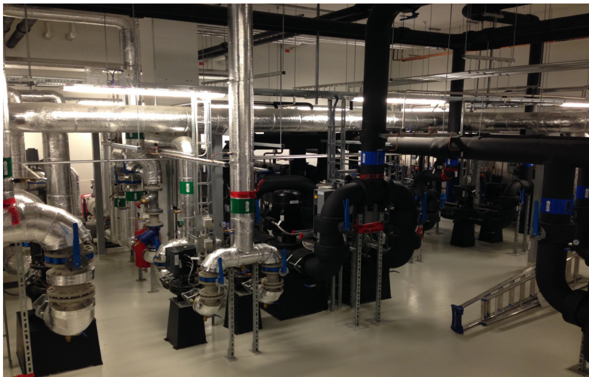
Figur 3: Utsnitt fra en typisk undersentral for sykehus med veksler for varme- og kjølekurser.
