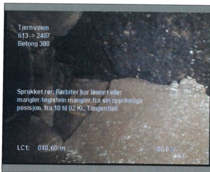
Foto: S_Sectionname_40,6_084725_1_A.JPG 40,6m, Sprukket rør, Rørbiter har løsnet eller mangler/teglstein mangler fra sin opprinnlige posisjon, fra 10 til 02 Kl., Tangentiell
