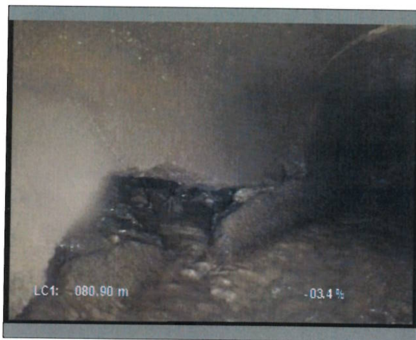
Foto: S_Sectionname_80,9_085450_1_B.JPG 80,9m, Sprukket rør, kollaps, fra 05 til 09 Kl., Tangentiell
