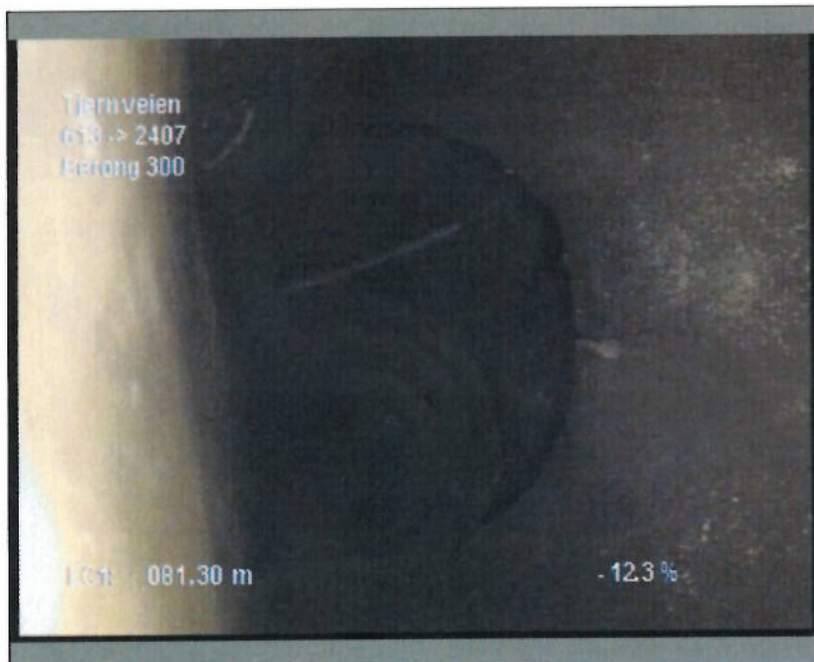
Foto: S_Sectionname_81,3_085552_1_A.JPG 81,3m, Sprukket rør, kollaps, fra 12 til 12 Kl., Kompleks
