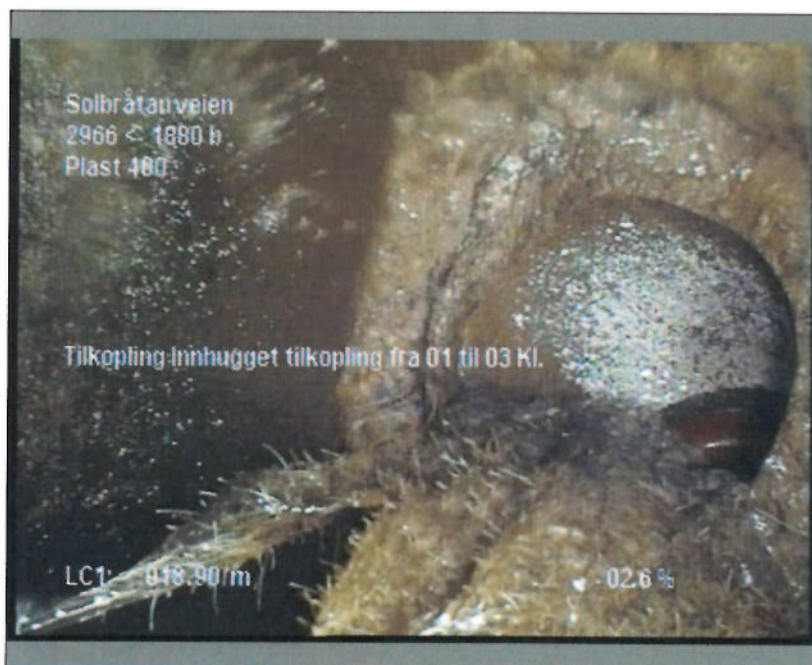
Foto: S_Sectionname_18,9_113409_6_A.JPG 18,9m, Tilkopling Innhugget tilkopling fra 01 til 03 Kl.
