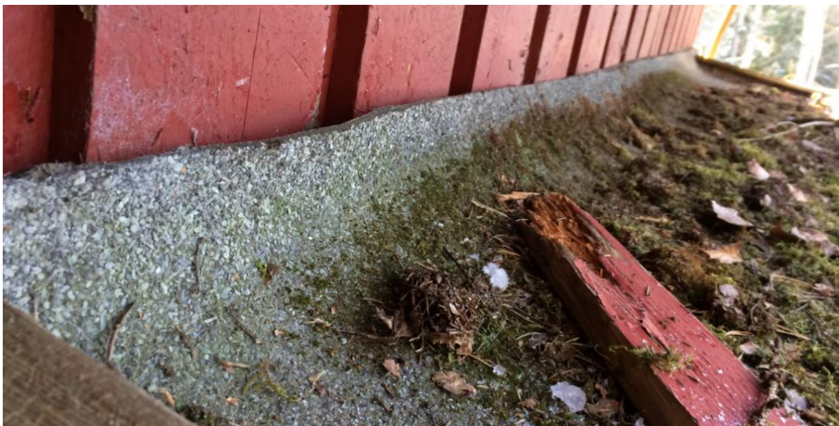
Bilde 12 – Asfaltpapp på tak på påbygg. Vindsperre: se bilde nr 02.
