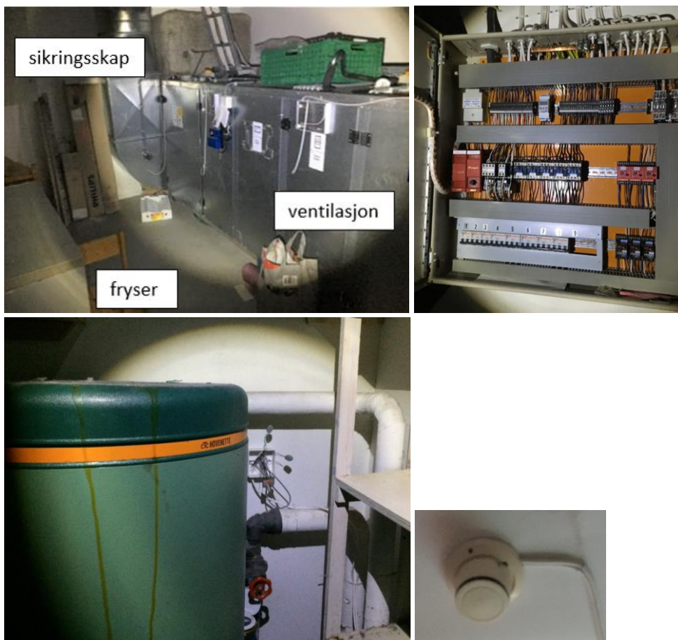
Bilde 18 – Noe av observert EE-avfall i hovedbygningen. Ikke alle forekomster ble fotografert.
