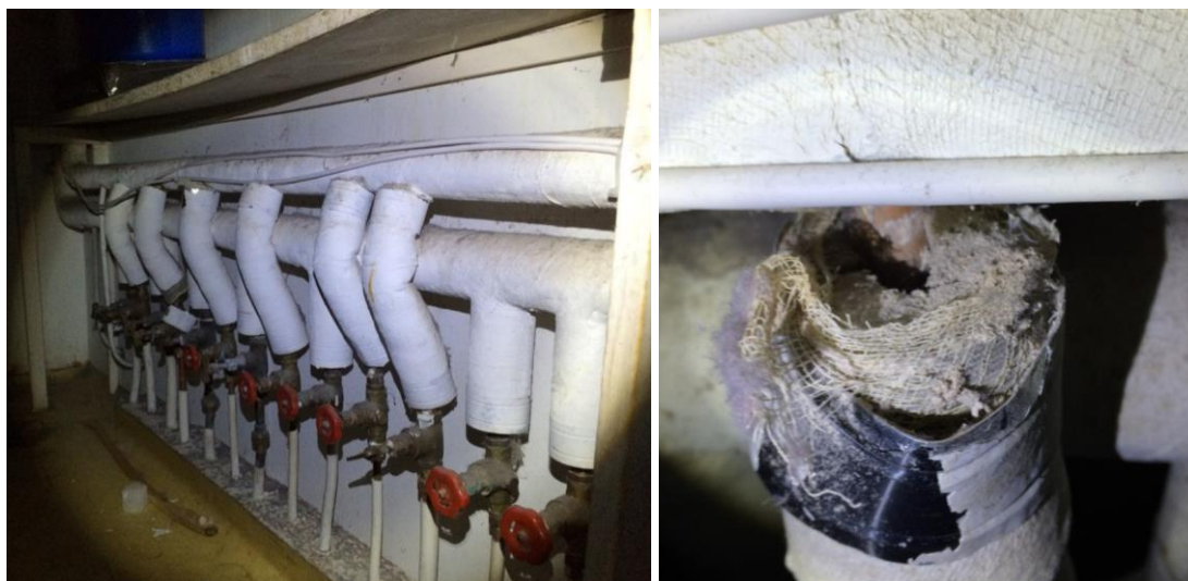
Bilde 17 – Rørisolasjon av cellegummi, rom 131
