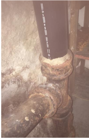
Bilde 17 – Observert PVC tilknyttet soilrør i kjeller
