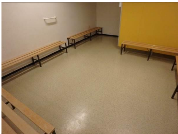
Bilde 18 viser vinylbelegg og vinyllister i garderobe i 1. etasje, og som skal håndteres som farlig avfall med ftalater dersom det berøres.
