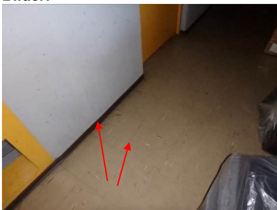
Bilde 15 viser harde vinylfliser og vynyllister i gang 1 i kjeller som skal håndteres som farlig avfall med ftalater.
