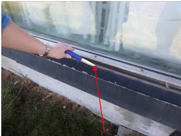
Bilde 27 viser fugemasse på fasade. All myk fugemasse som berøres skal håndteres som farlig avfall med klorparafiner.
