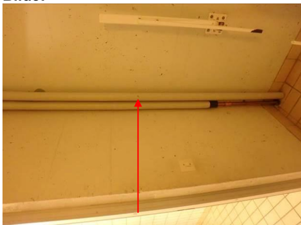
Bilde 8 viser cellegummi observert som rørisolasjon på toalett i 1. et. Cellegummi skal håndteres som farlig avfall med bromerte flammehemmere.
