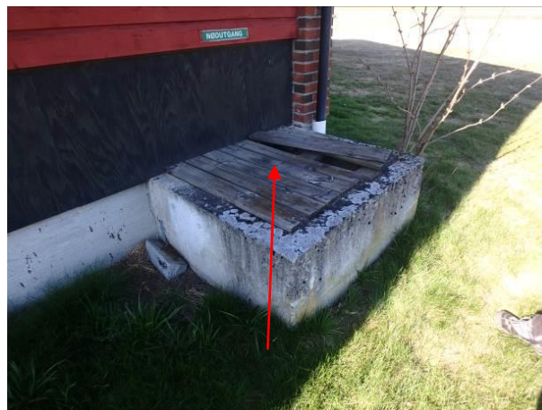
Bilde 10 viser CCA-impregnert trevirke spikret over nødutgang fra tilfluktsrom. CCA håndteres som farlig avfall.
