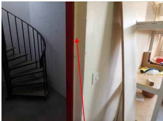
Bilde 24 viser fugemasse rundt dør. All myk fugemasse som berøres skal håndteres som farlig avfall med klorparafiner.
