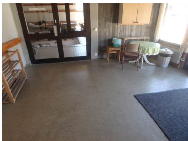
Bilde 19 viser vinylbelegg i gang i 1. et., og som skal håndteres som farlig avfall med ftalater dersom det berøres.
