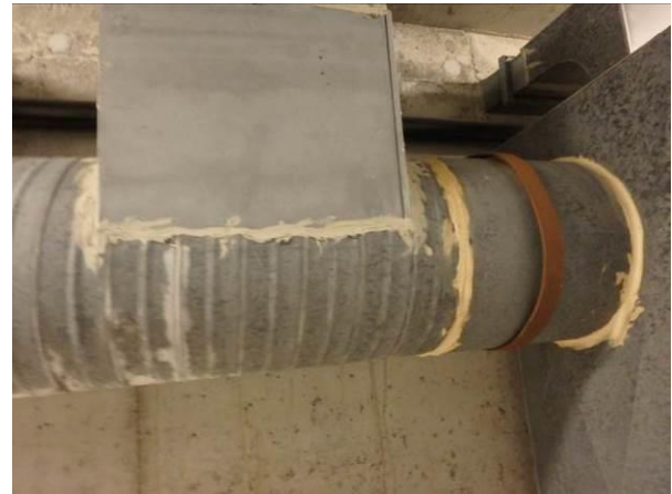
Bilde 6 viser fugemasse på ventilasjonskanal som ble analysert for asbest. Det ble ikke påvist asbest i fugemassen.
