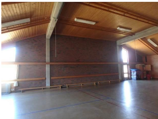
Bilde 17 viser vinylbelegg i gymsal i 1. et., og som skal håndteres som farlig avfall med ftalater dersom det berøres.
