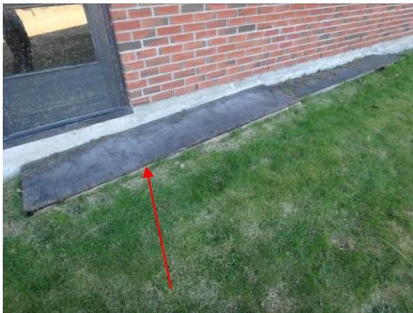
Bilde 11 viser CCA-impregnert trevirke delvis nedgravd. CCA håndteres som farlig avfall.
