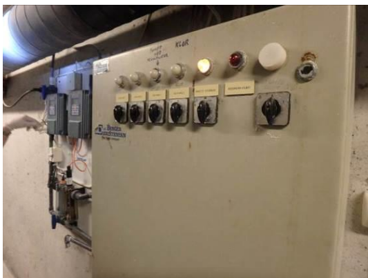
Bilde 13 viser sikringsskap som eksempel på EE-avfall.
