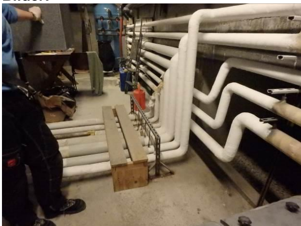
Bilde 9 viser trapp/overgang av CCA-impregnert trevirke i rom under basseng. CCA håndteres som farlig avfall.
