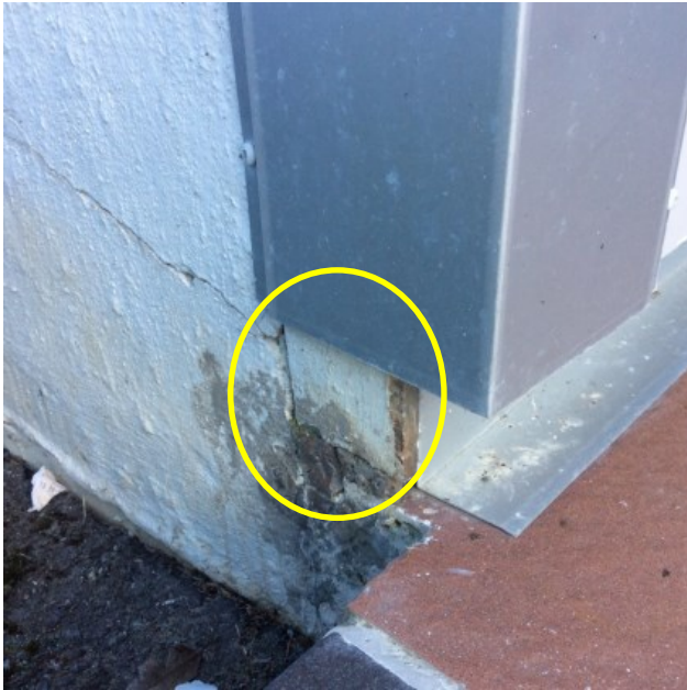
Bilde 6: Viser plassering av andre fasadeplate som antas å inneholde asbest (midt på bildet)
