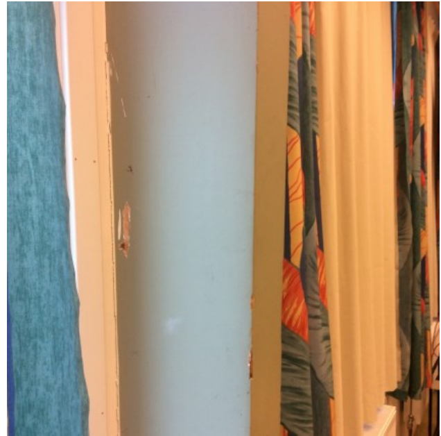
Bilde 32: Maling på søyler i 2.etg i fløy B inneholder tungmetaller over gjeldene grenseverdier
