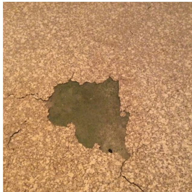
Bilde 34: Det ble påvist PCB 7 i dette gulvbelegget. Gulvbelegget er klassifisert som farlig avfall pga innhold av tungmetaller og at det vil bli vanskelig å rensse gulvbelegget for malingen
