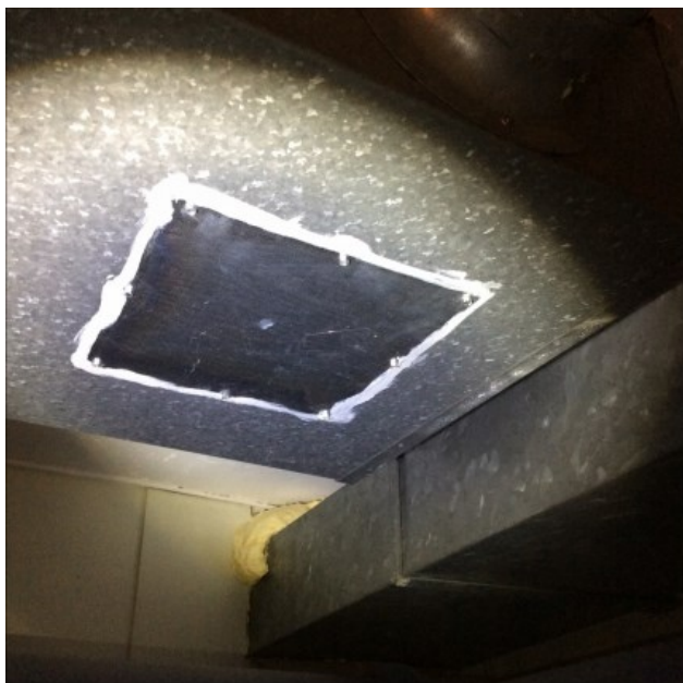
Bilde 62: Skumplast som er synlig der ventilasjonskanal går inni veggen
