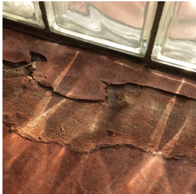
Bilde 26: Gulvbelegg på biblioteket er påvist å inneholde tungmetaller over gjeldene grenseverdier (1.etg)
