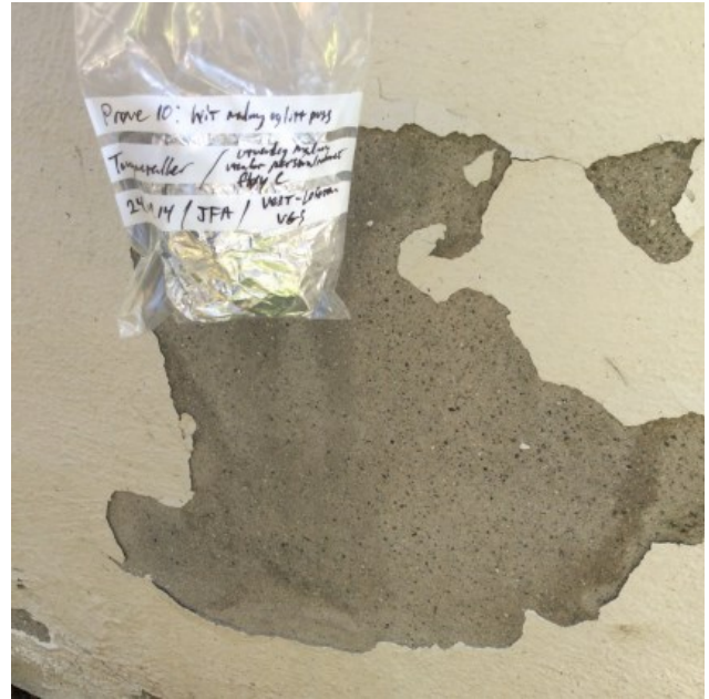
Bilde 40: Utvendig maling på fløy C er ikke påvist å inneholde tungmetaller over gjeldene grenseverdier
