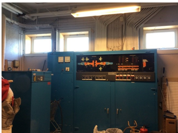
Bilde 59: Gammelt ventilasjonssystem
