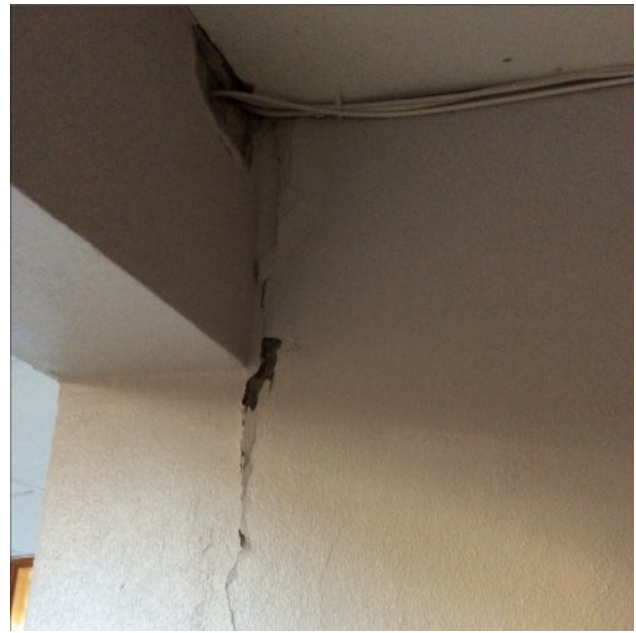
Bilde 10: Maling og puss i gang inneholder PCB 7 (1.etg)
