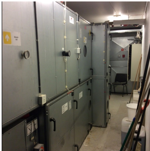
Bilde 56: Ventilasjonsaggregatet som hører til fløy A. Dette rommet er tatt med i kartleggingen fordi tilgangen var via fløy B.
