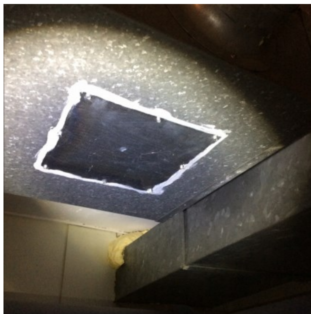
Bilde 8: Hvit belegg som inneholder asbest. Dette belegg ble kun påvist ett sted (rom 037), men det kan ligge skulte forekomster som ikke ble oppdaget under befaringen
