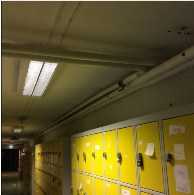
Bilde 50: Flere plasser er cellegummi malt hvit. Det er registrert 265 løpemeter cellegummi i bygget
