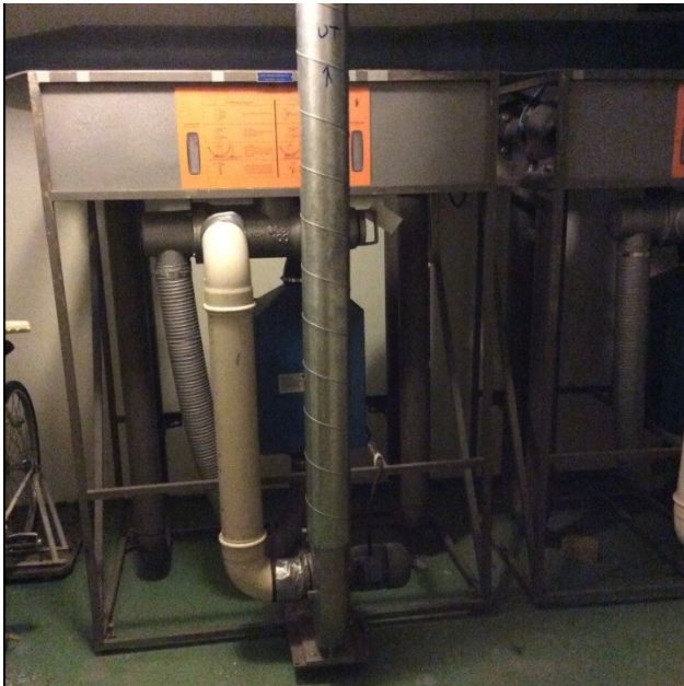
Bilde 53: Gammelt ventilasjonssystem som ikke er i bruk. Det er også påvist asbest i et hvit belegg på dette systemet
