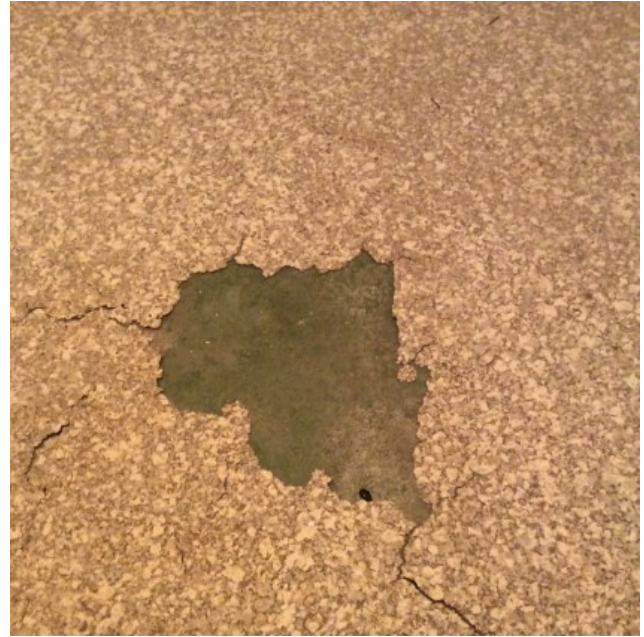
Bilde 22: Det ble påvist PCB 7 i dette gulvbelegget. Gulvbelegget er klassifisert som farlig avfall pga innhold av tungmetaller og at det vil bli vanskelig å rense gulvbelegget for malingen
