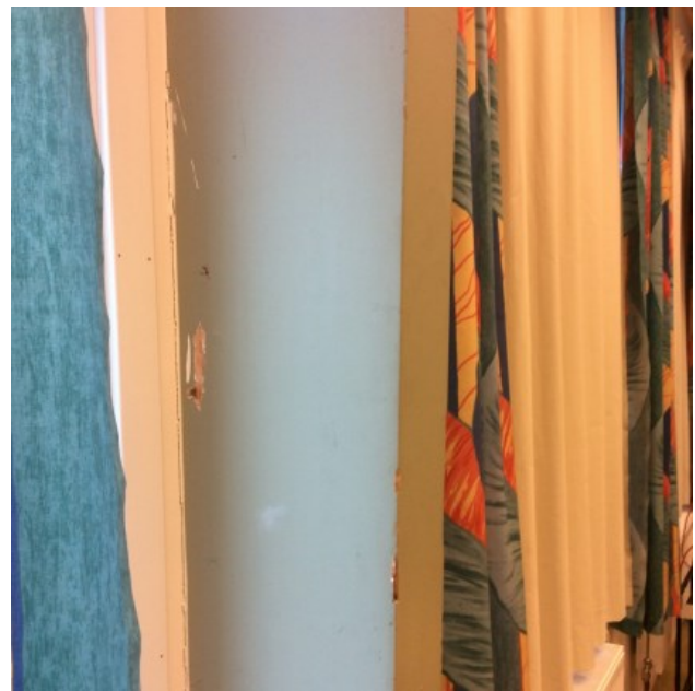
Bilde 12: Maling på søyler i 2.etg i fløy B
