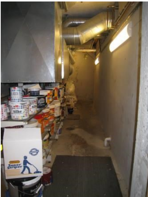
Bilde 48: Eksempelbilde. Hensatt maling/kjemikalier. Fra ventilasjonsrom u.etc.
