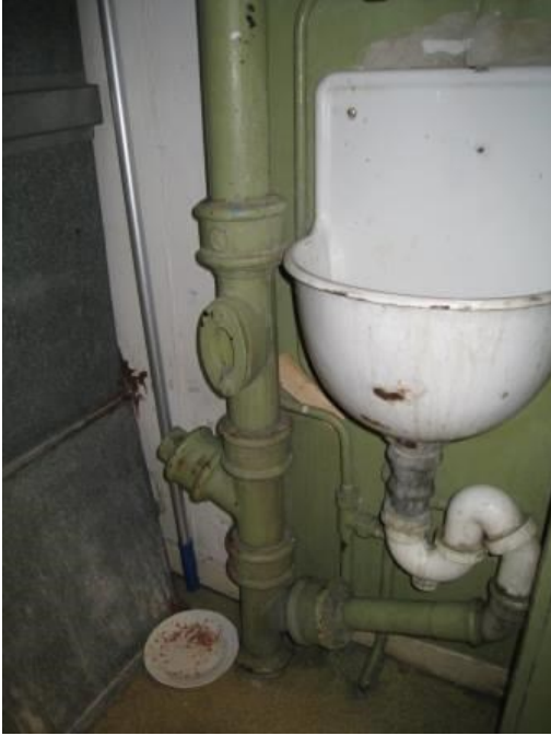
Bilde 20: Eksempelbilde, soilrør med blyskjøt. Fra bøttekott.
