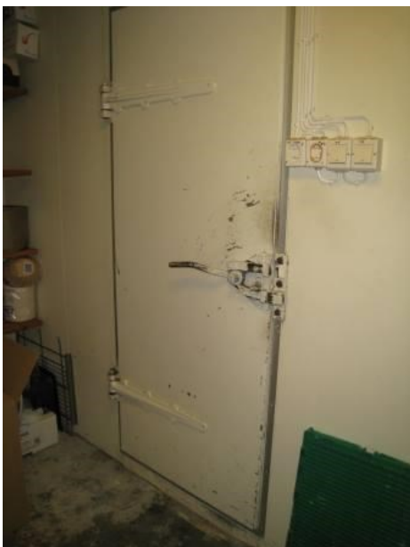
Bilde 40: Eksempelbilde EE-avfall. Fra kjølerom U.etg.
