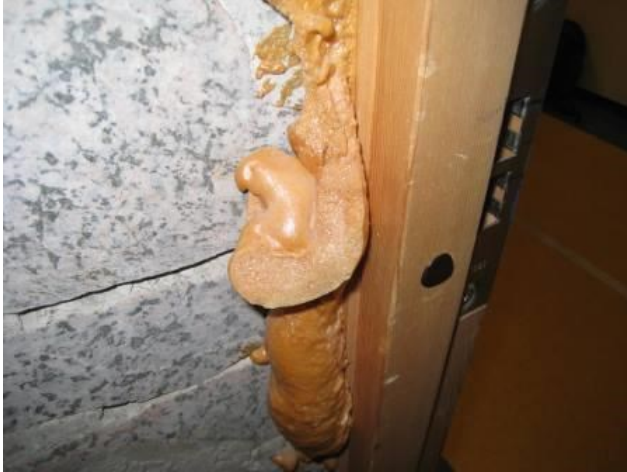
Bilde 45: Eksempelbilde, bruk av pur-skum rundt dør. Fra ventilasjonsrom u.etg.
