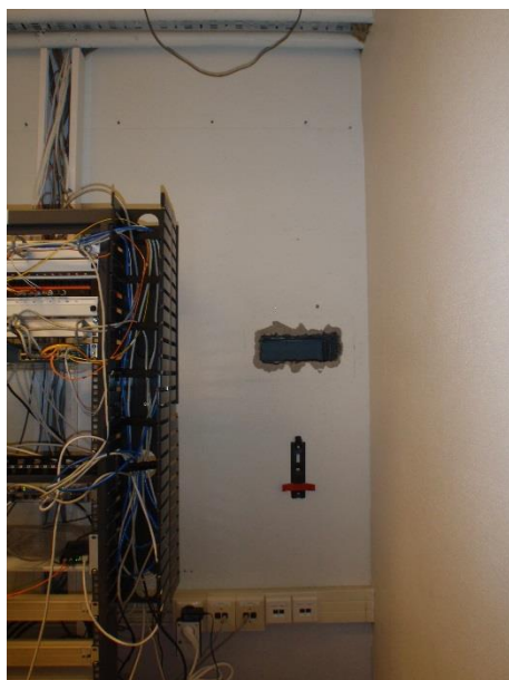
Bilde 10: Del C, underetasje. Åpen hull i vegg fra serverrom.
