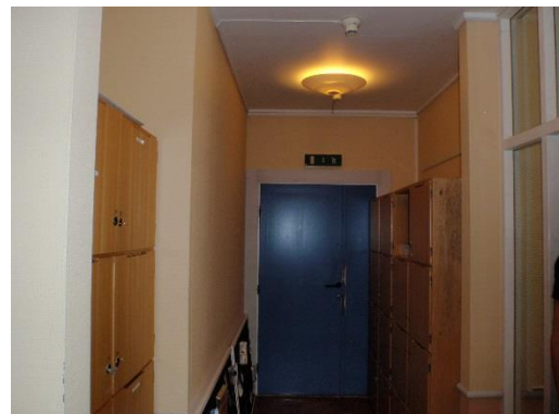
Bilde 20: Personalrom, del C, 1. etasje. Merking over dør/port i seksjoneringsvegg.
