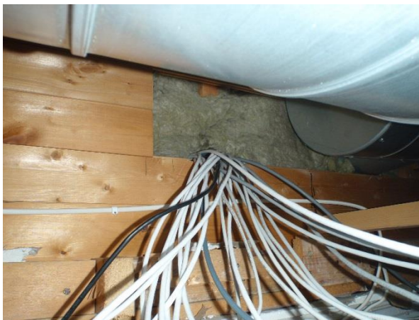
Bilde 18: Eksempel på åpen gjennomføring fra hulrom over korridor/rømningsvei til klasserom, 1. etasje, del B.
