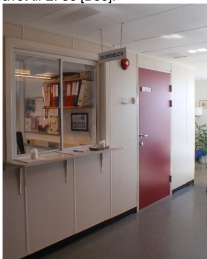
Bilde 5: Del B, 1. etasje. Uklassifisert luke mellom ekspedisjon/kontor og rømningsvei.
