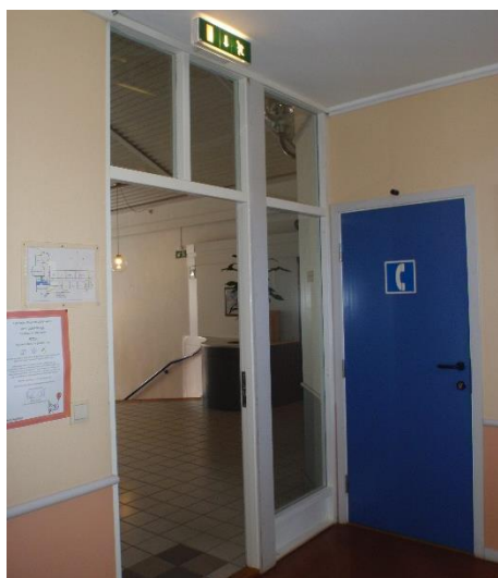
Bilde 6: Del C, 1. Etasje. Trådglass i vegg fra personalavd. til rømningsvei/trapperom.
