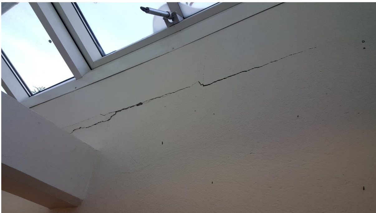
Figur 2 - Riss i vegg med TG3 (1)
