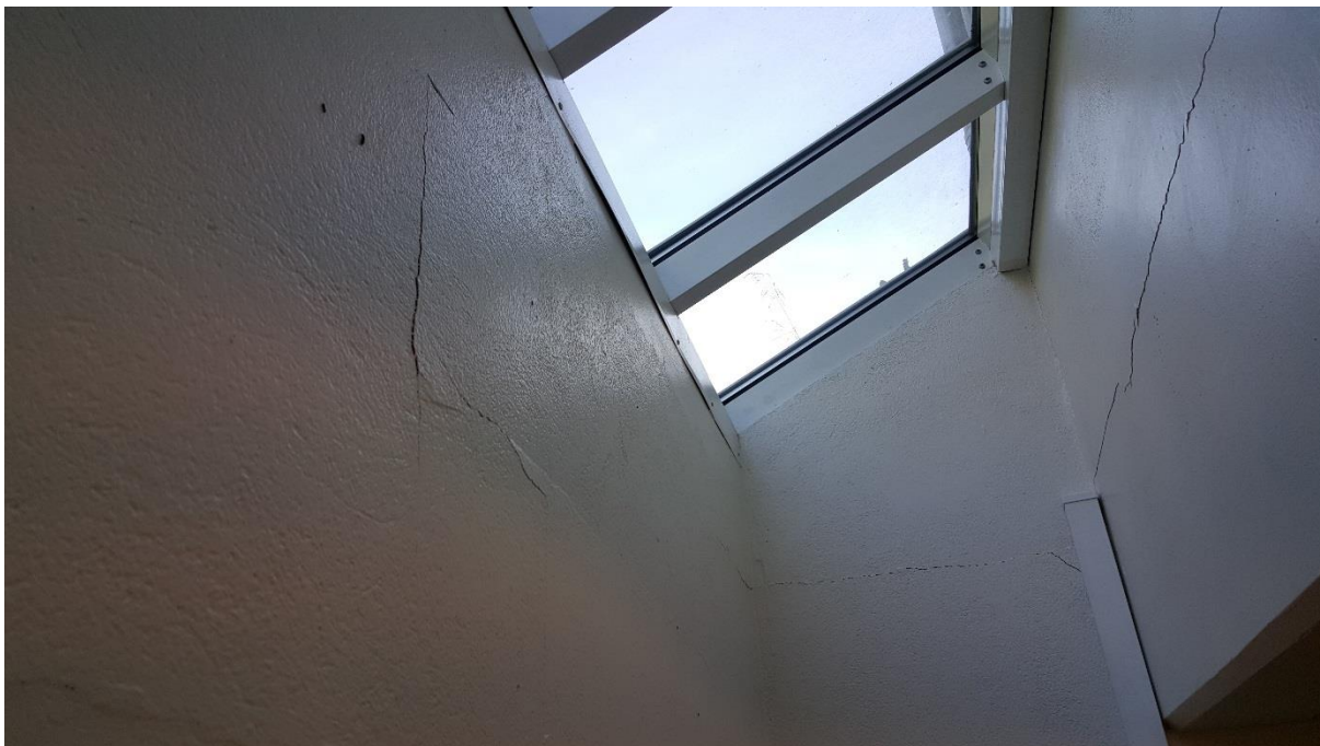
Figur 3 - Riss i vegg med TG3 (2)
