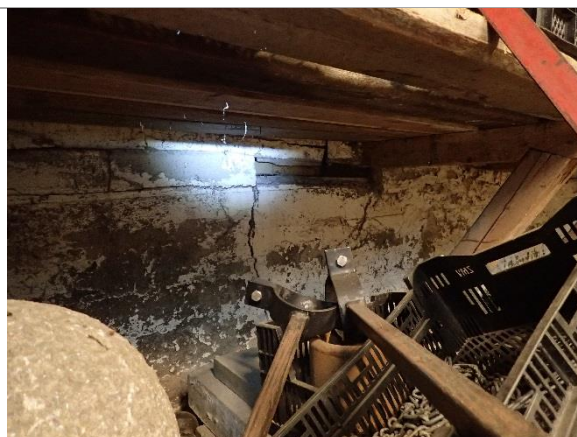
Bilde 6: Mur i garasjeuthus med malt puss.
