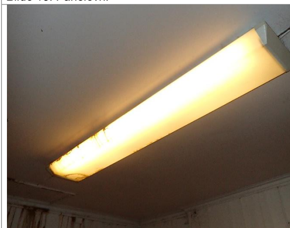
Bilde 21: Lysarmatur med lysstoffrør.
