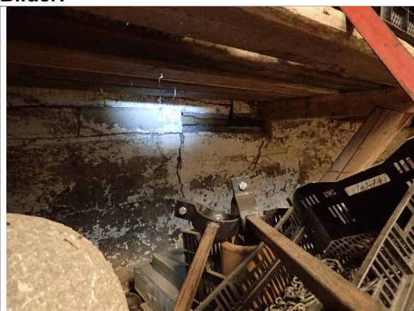
Bilde 14: Maling på mur i garasjeuthus.
