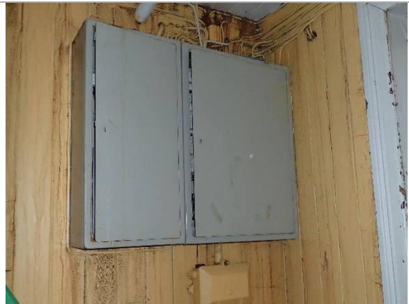
Bilde 20: Eldre sikringsskap.
