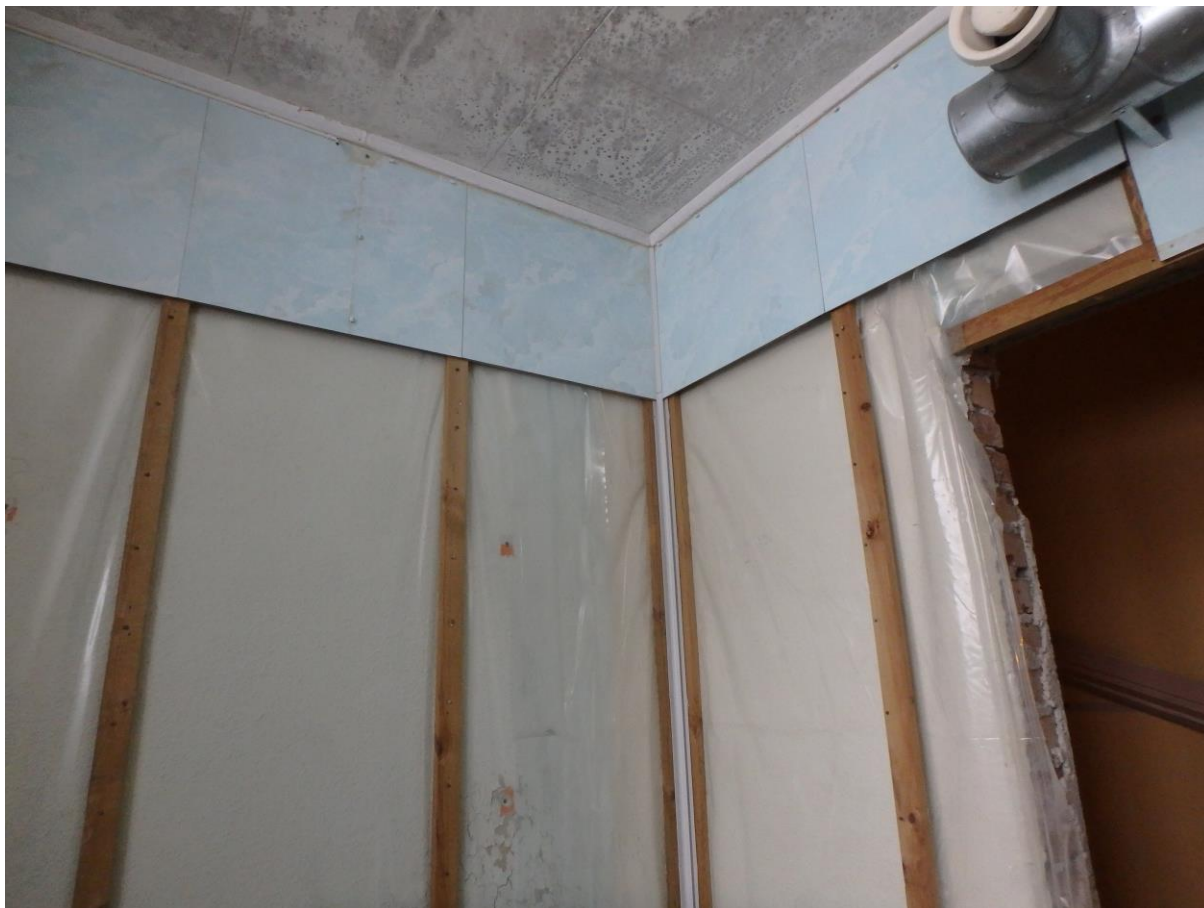
Figur 6: Lyseblå paneler som inneholder pentaklorfenol. I samme rom ble det registrert CCA-impregnert trevirke.
