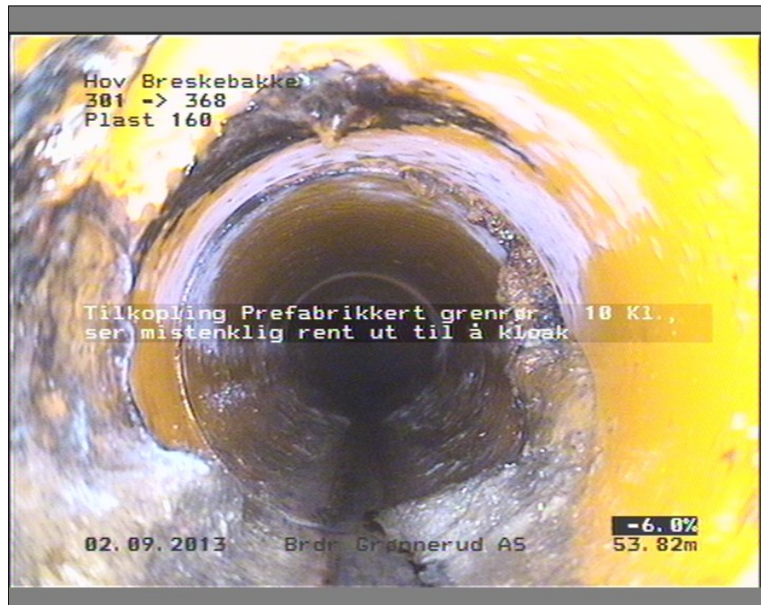
Foto: 2_2_18_A.JPG 53,82m, Tilkopling Prefabrikkert grenrør. 10 Kl., ser mistenkelig rent ut til å kloak
