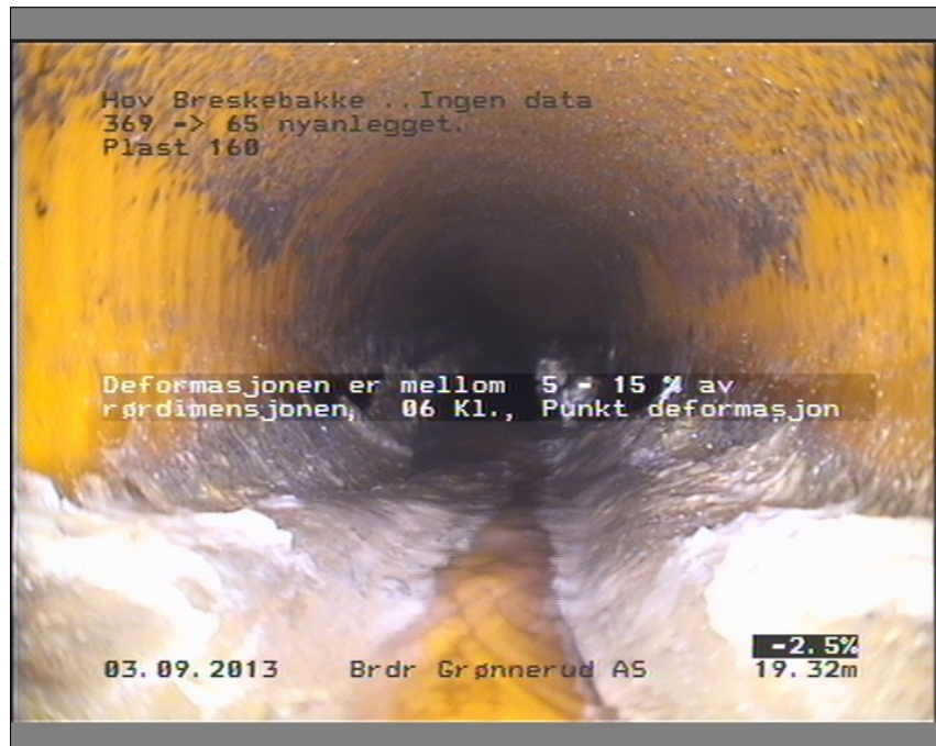
Foto: 5_5_61_A.JPG 19,32m, Deformasjonen er mellom 5 - 15 % av rørdimensjonen, 06 Kl., Punkt deformasjon
