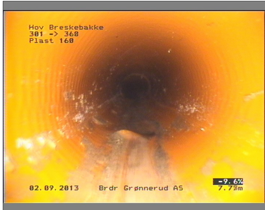
Foto: 2_2_15_A.JPG 3,57m, Deformasjonen er 5 % eller mindre av rørdimensjonen, fra 03 til 09 Kl., Punkt deformasjon, Start
