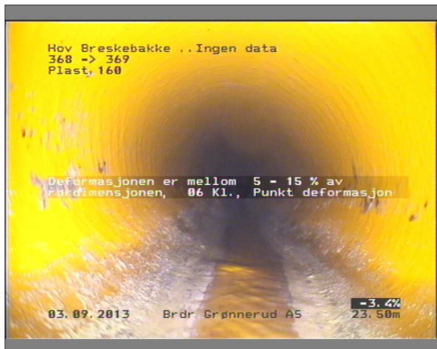
Foto: 4_4_54_A.JPG 23,5m, Deformasjonen er mellom 5 - 15 % av rørdimensjonen, 06 Kl., Punkt deformasjon
