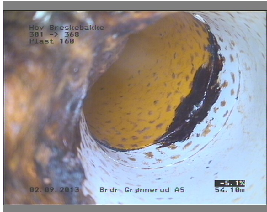
Foto: 2_2_18_B.JPG 53,82m, Tilkopling Prefabrikkert grenrør. 10 Kl., ser mistenkelig rent ut til å kloak
