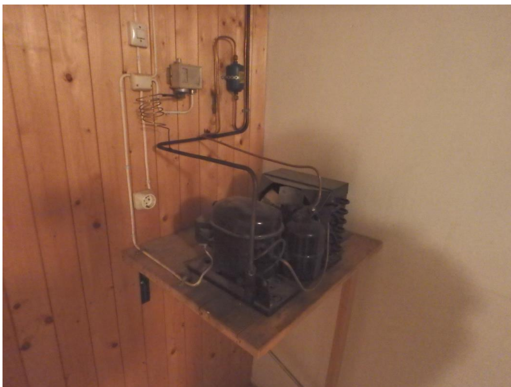
Figur 14: Kjøleapparat fører inn til kjølerommet bak.
