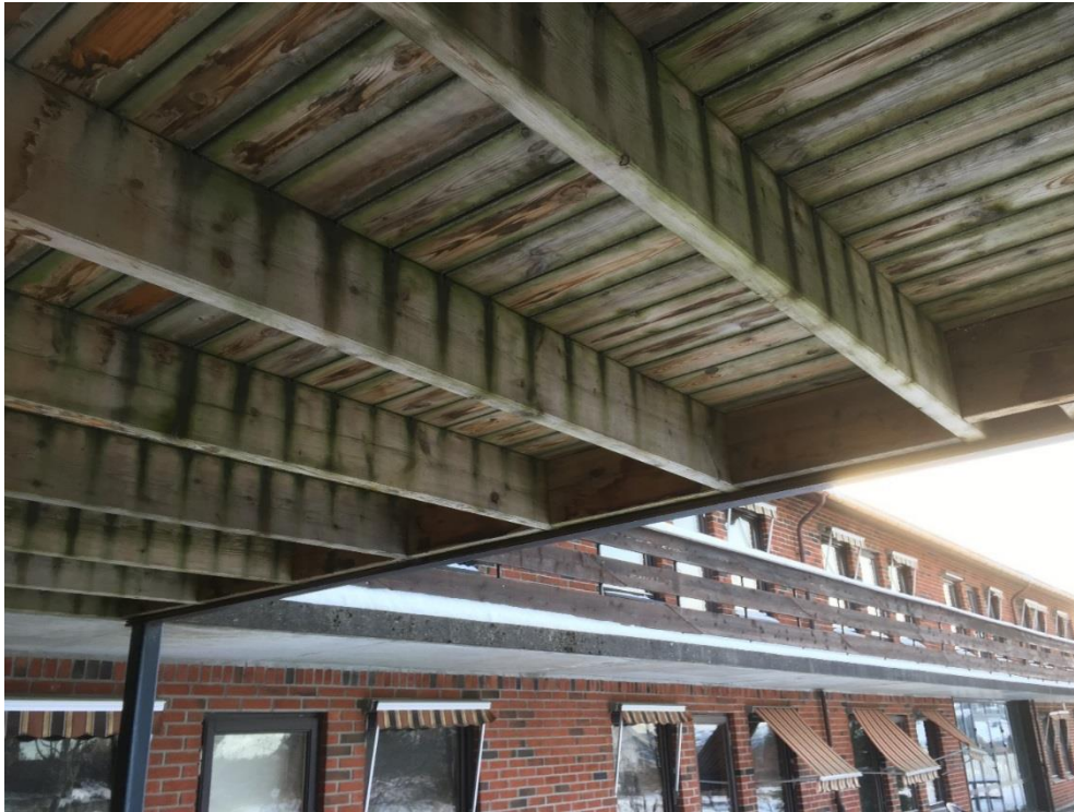
Figur 8: CCA-impregnert trevirke på undersiden av balkong ved vestfløyen, resterende er av betong.
