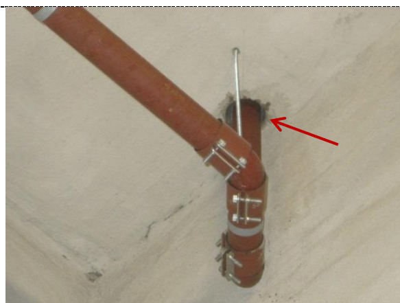
Bilde viser rørgjennomføring i etasjeskille som ikke er branntettest.
