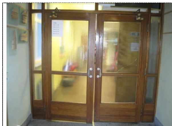
Bilde viser utett dør med trådglass mellom korridor utenfor klasserom og trapperom (rømningsvei)
