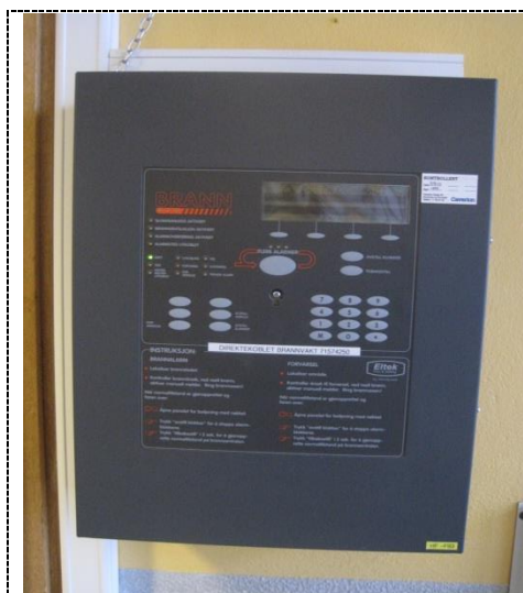
Bilde viser brannsentral
