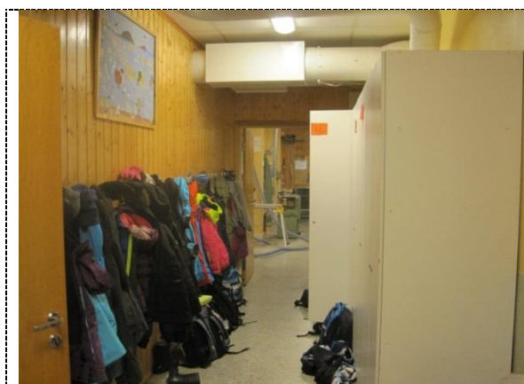
Bilde viser rømningskorridor i sokkel i gymnastikkbygg hvor det er benyttet brennbar kledning. Korridor brukes også som garderobe.
