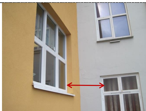
Bilde viser uklassifiserte vinduer i innvendig hjørne mellom skolebygg 1 og 2, minste avstand mellom vinduene er 2,3 m.
