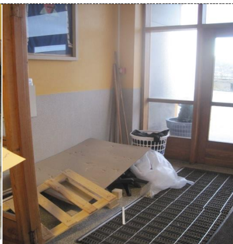
Bilde viser brennbart materiale i hoved inngang.
