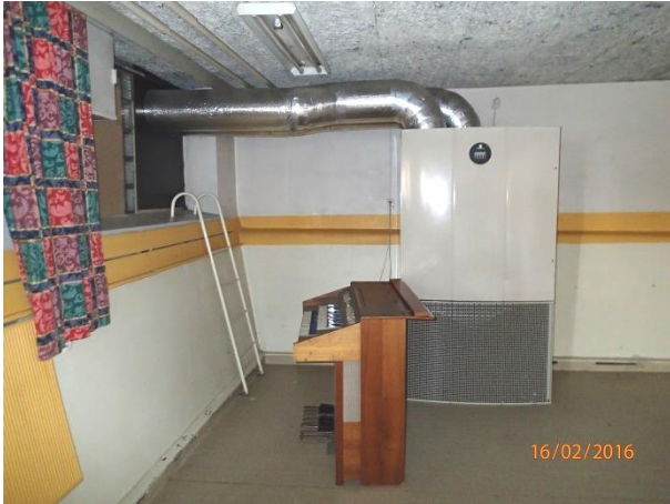
Bilde 24: Eksempel på ventilasjonsaggregat som ble registrert i rom 7AK.
