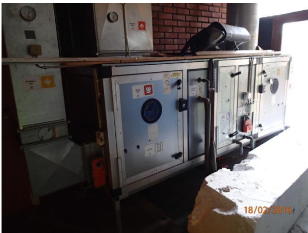
Bilde 28: Eksempel på ventilasjonsaggregat. Registrert i rom 10C.
