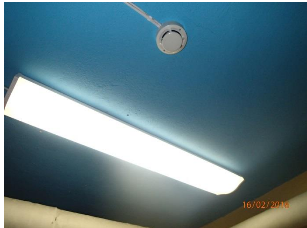
Bilde 21: Eksempel på lysarmatur og røykvarsler.
