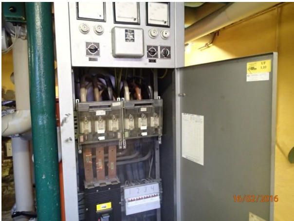
Bilde 20: Eksempel på styringskap som ble registrert i rom 1AK.
