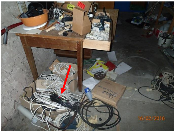
Bilde 22: Hensatte kabler og diverse EE-avfall som ble registrert i rom 3AK.
