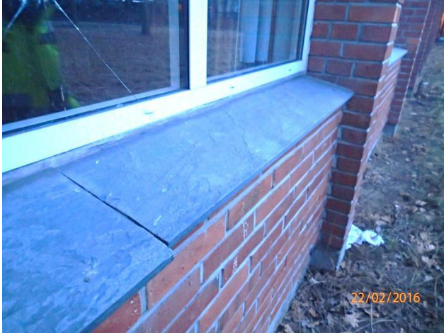
Bilde 8: Vindusbrett på fasade av fløy C som kan inneholde asbest
