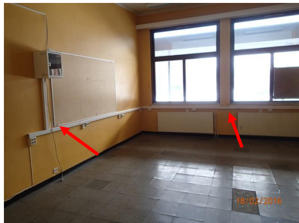
Bilde 29: Eksempel på kabelkanal langs veggen i bygget.
