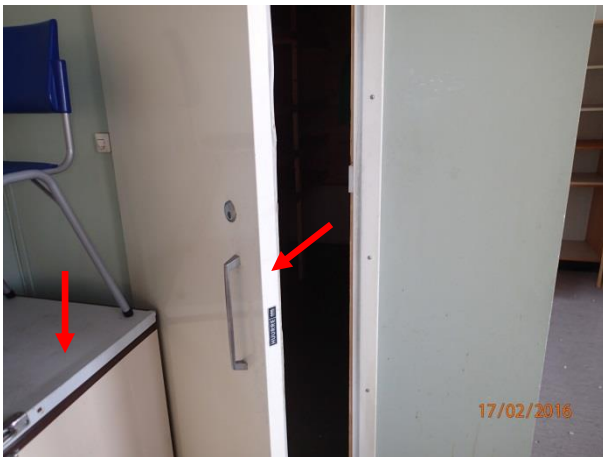
Bilde 31: Kjøleromsdør som ble registrert i kjøkkenet, rom 14A. Denne kan inneholde KFK. Samme gjelder fryseboksen som er ved siden av døren.
