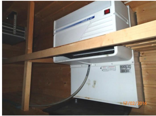
Bilde 33: Kjøleaggregat i kjølerommet.
