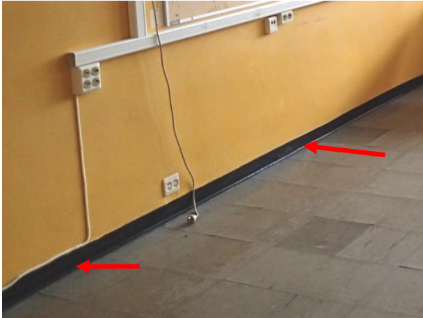
Bilde 17: Eksempel på vaskelister i bygget.
