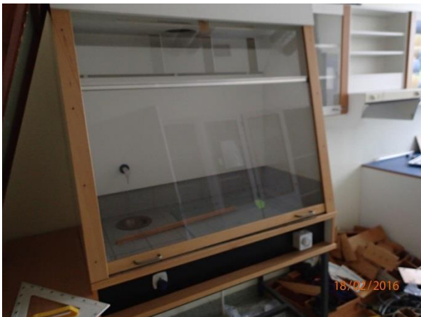
Bilde 10: Avtrekksskap registrert i rom 8C.
