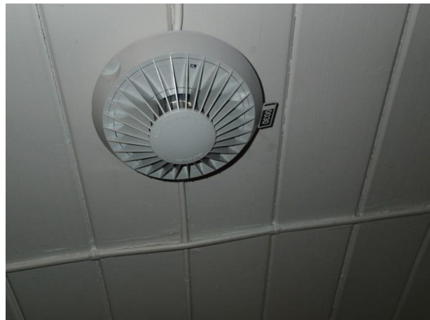
Bilde 17: Eksempel på røykvarslere i bygget.
