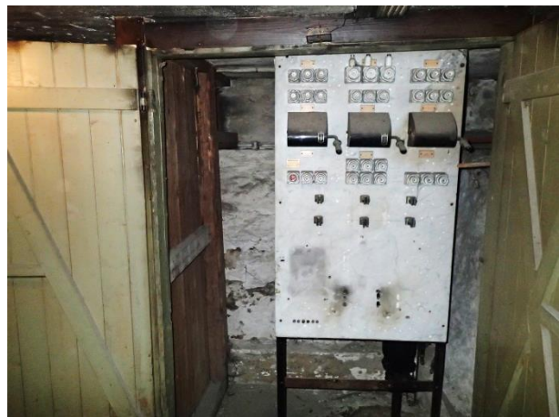
Bilde 19: Eksempel på styringskap i U.et.
