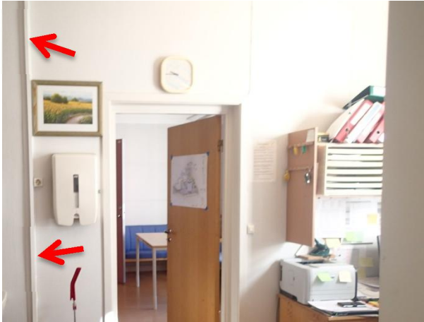
Bilde 20: Eksempel på kabelkanal i driftskontor, 1.et.
