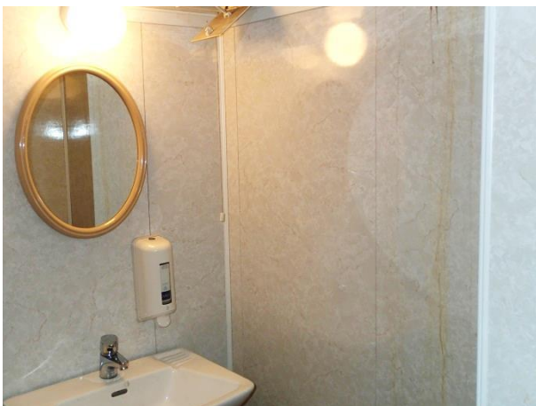
Bilde 21: WC1 og WC2 i U.et er dekket med baderomsplater
