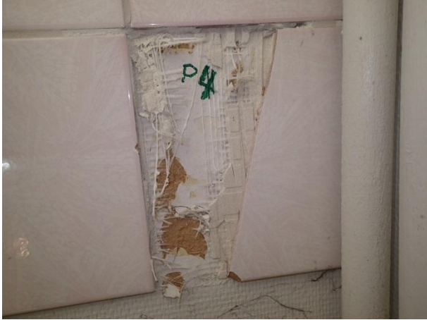
Bilde 4: Prøve 4 viste ikke innhold av asbest.
