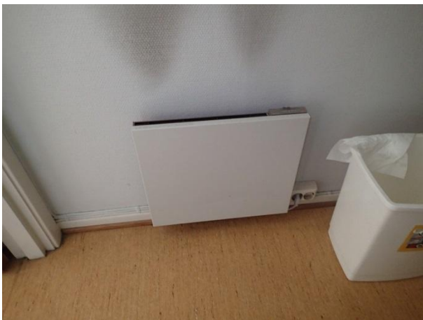
Bilde 18: Eksempel på panelovn som ble registrert i toalett 1.et.
