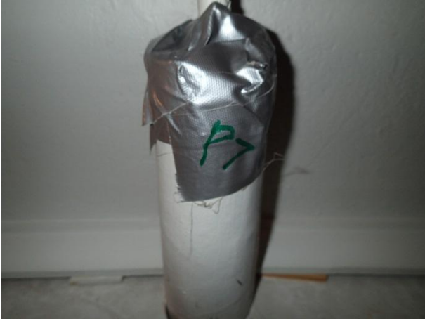
Bilde 7: Prøve 7 påviste ikke asbest
