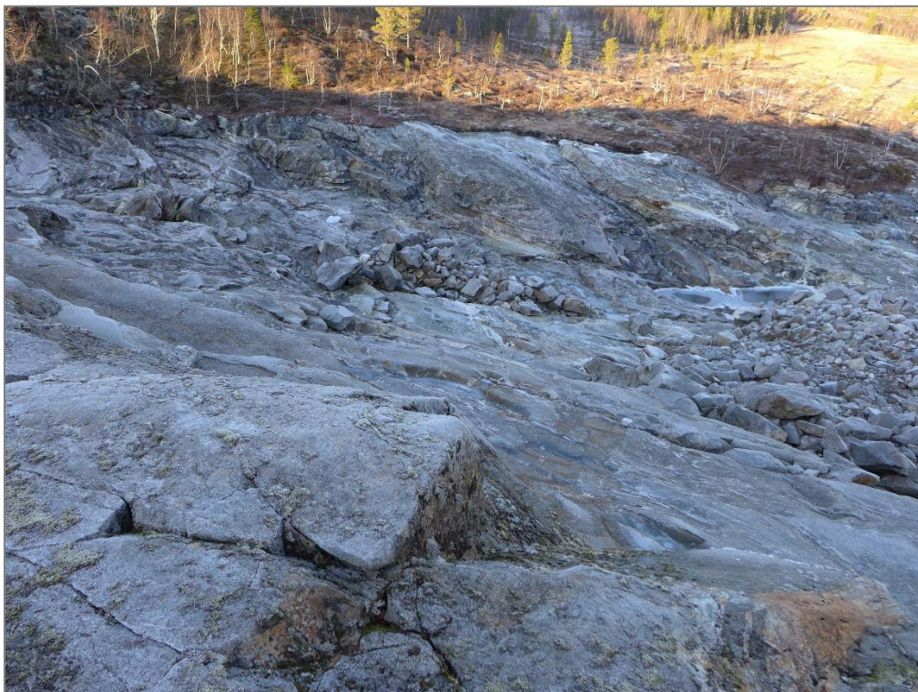
Bilde 12 Bergmassen ved avsats i terrenget mellom platå ved overløp og elveleiet videre nedstrøms dette. Bergmassen fremstår som kompetent og lite oppsprukket. Stor sprekkeavstand. Granittisk gneis med bånd av glimmergneis.
