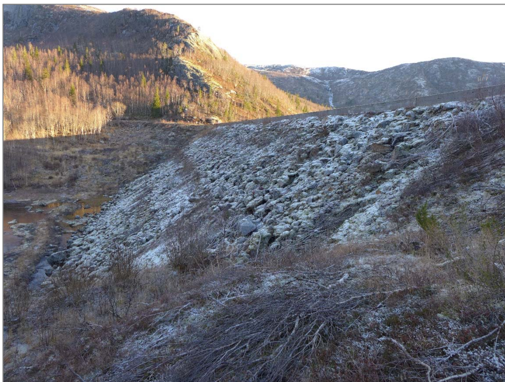
Bilde 2 Dam Hundålvatn, bilde tatt mot øst. Eksisterende plastring delvis begrodd med mose.
