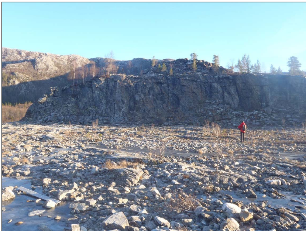
Bilde 8 Skjæring etablert i forbindelse med steinuttak i anleggstiden. Det er observert avløste steiner og blokker i skjæringen.
