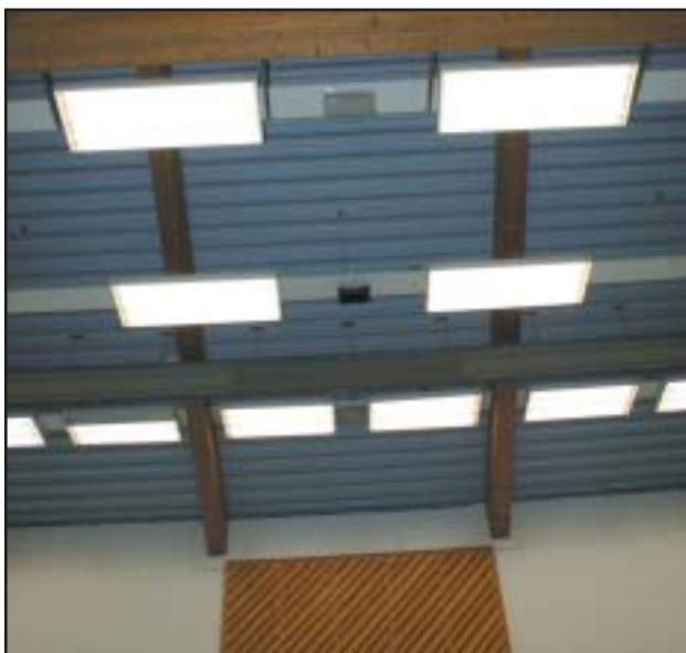
Bilde: Eks. på lysanlegg med lysstoffrørarmaturer.
