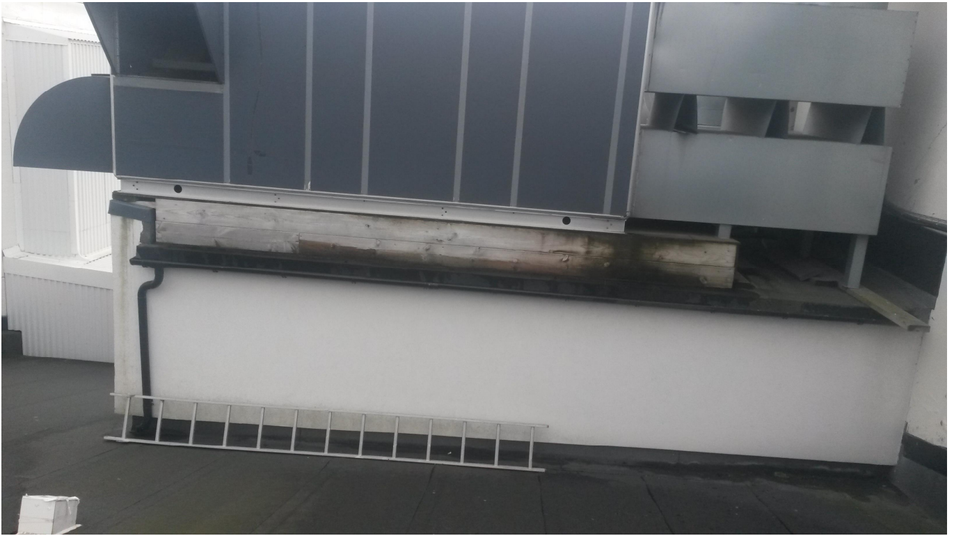
Eksist aggregat og utvendige kanaler for Nautilus(Actic) på tak.
