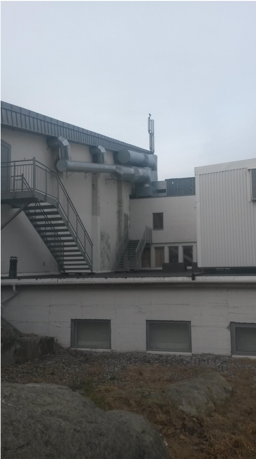
Eksist aggregat og utvendige kanaler for Nautilus(Actic) på tak.
