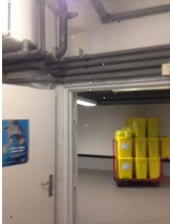
Vannrør til basseng v UPS rom syd
