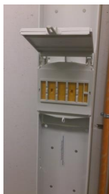
Figur 6: Eksempel på avtappingspunkt som skal etableres på nye UPS strømskinner
