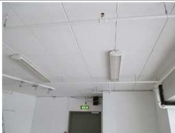
Bilde 3.2 Asbestholdige himlingsplater i plan 2
