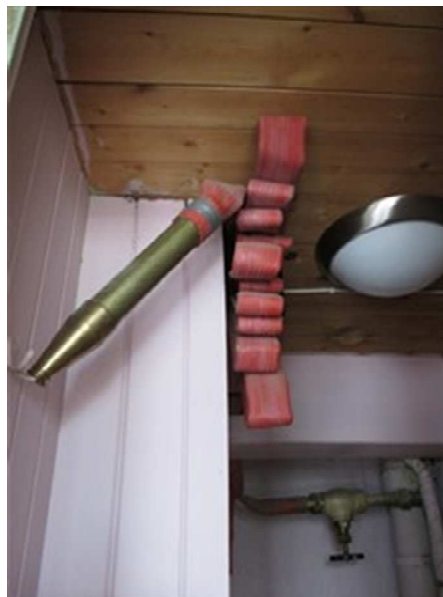
Bilde 3.4 Gammel tøybrannslange som kan inneholde asbest
