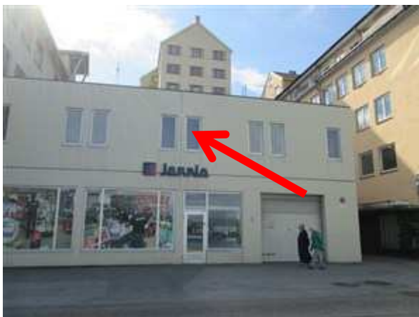
Bilde 3.11 Vinduer i 2. etg. som har vært tildekket fra innside og derav ikke har vært mulig å kontrollere. Det antas derav at disse er fra byggeår, ca. 2000.
