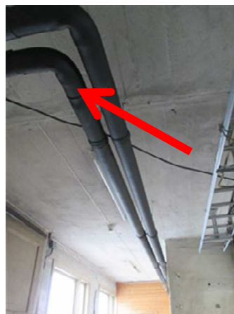
Bilde 3.8 Cellegummi som rørisolasjon i 3. etg.
