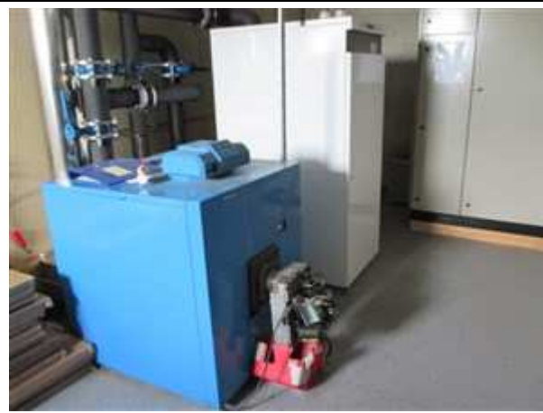
Bilde 3.14 Kombikjel i teknisk rom i 3. etg.
