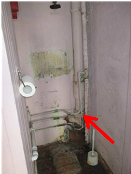
Bilde 3.5 Soilrør i 3. etg.
