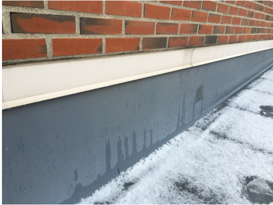
Foto 12 – Horisontalt sliss i murverk
