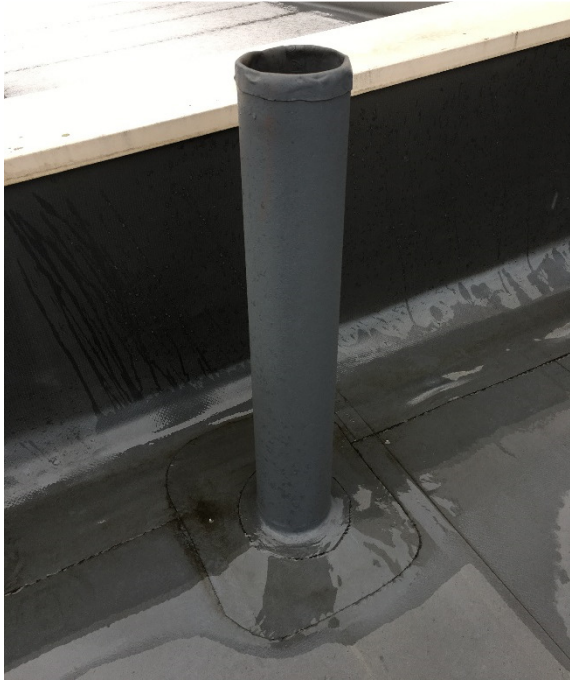
Foto 6 – Lufting – Typisk sirkulær gjennomføring
