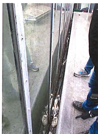
Fig 2 eksisterende renne som skal vekk.
