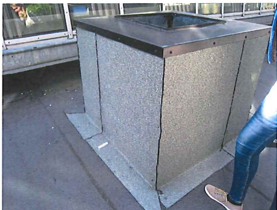
Figur 19: Foto av eksisterende ventilasjonskasser (Rambøll)
