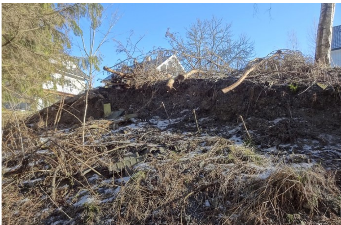
Figur 12: Begynnende utglidning nedenfor bebyggelse like bortenfor skredhendelsen i 2013. Det er utfyllt mye masse i skråningen. Enkel tilkomst fra bebyggelse, vanskelig tilkomst mot elva.
