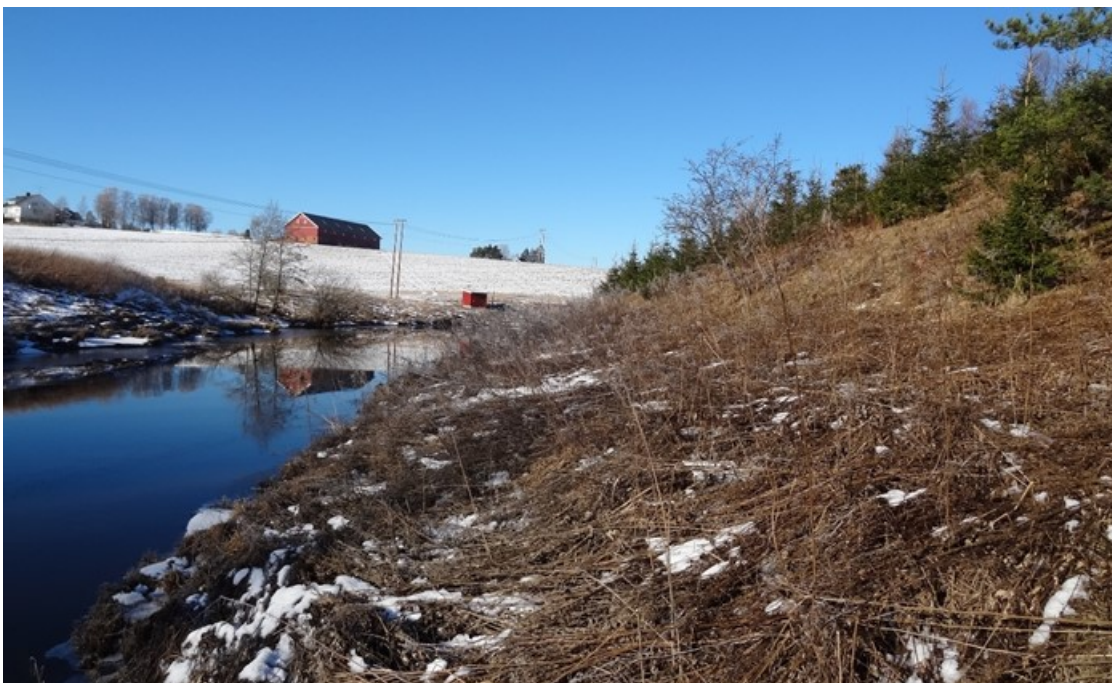
Figur 11: Skråning ned mot Rakkestadelva. Bratt og vanskelig tilkomst. Litt/noe erosjon på strekningen.
