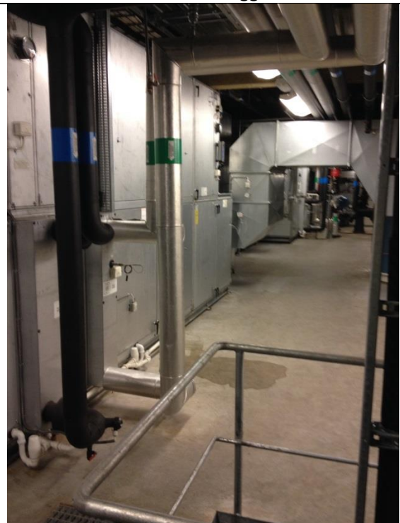
Bilde 4. Ventilasjonsaggregat 36.100 nærmest og 36.101 lengre inn i rommet.
