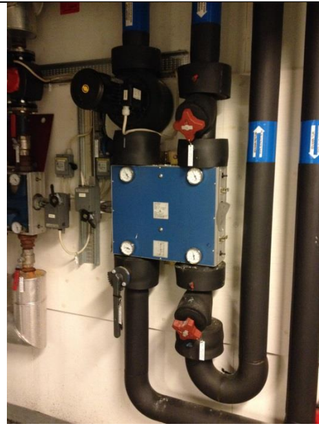
Bilde 3. Eksisterende shuntventiler som skal fjernes
