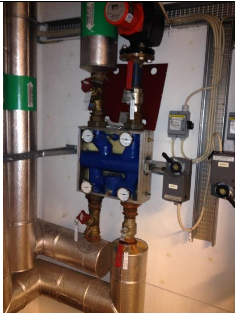
Bilde 3. Eksisterende shuntventiler som skal fjernes
