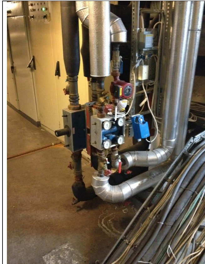
Bilde 3. Eksisterende shuntventiler som skal fjernes
