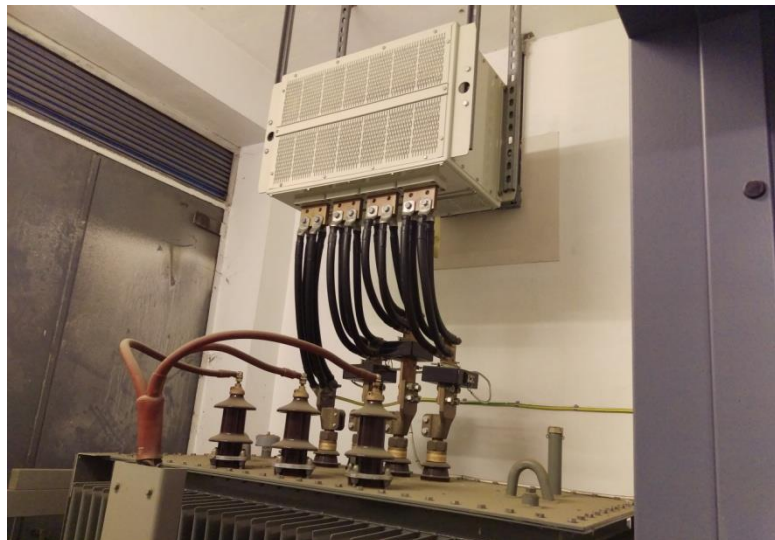
Tilkoblingspunkt for midlertidig løsning-Trafo T7
