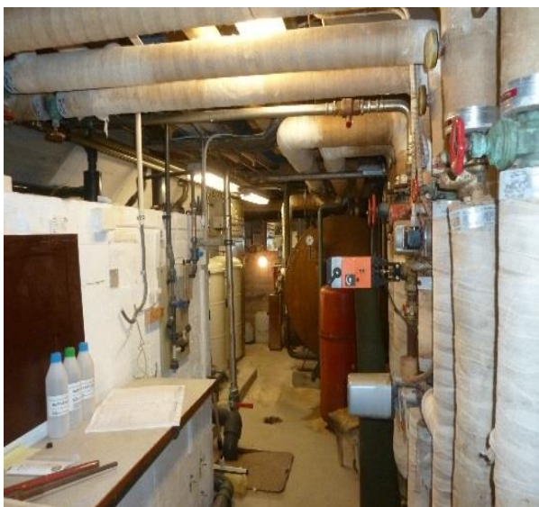
VVS-anlegg i kulvert og varmtvannstank.
