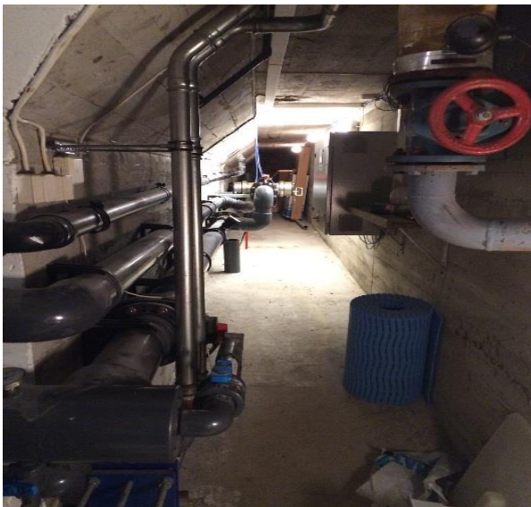
VVS anlegg i kulvert.
