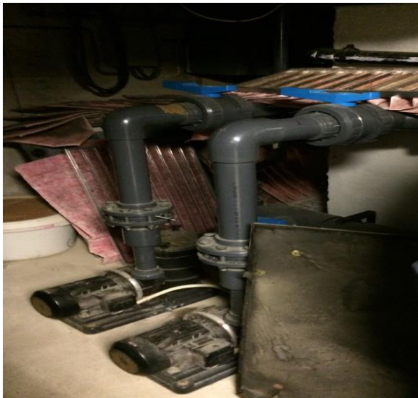
Pumper renseanlegg for svømmebasseng.
