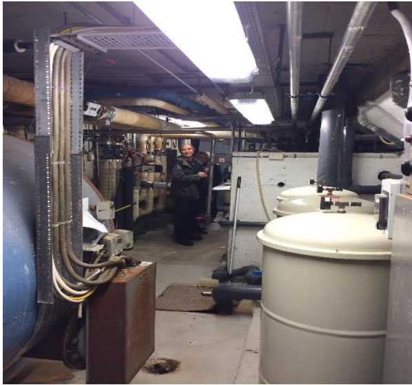
Deler av renseanlegg for svømmebasseng.
