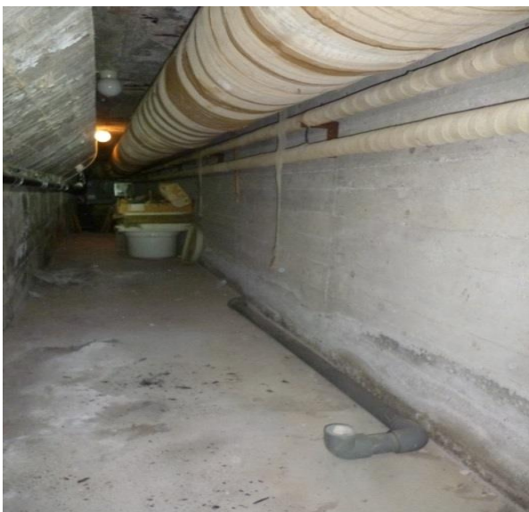
VVS anlegg i kulvert.
