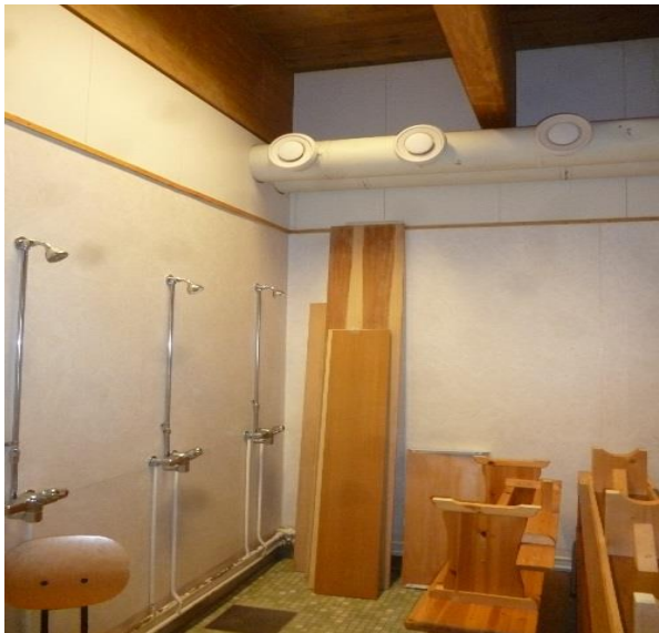
Deler av dusjanlegg i 1etg.
