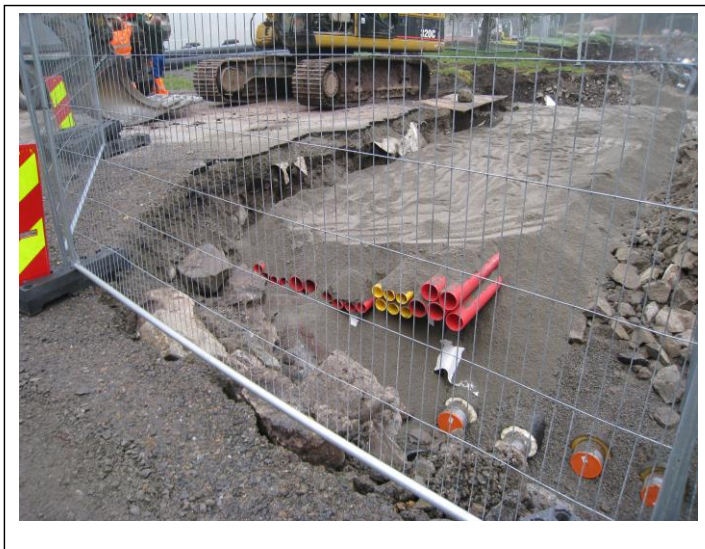
Fig1: Bilde tatt fra kabelgrøft på Haakonsværn med mange kabler i flere lag!
