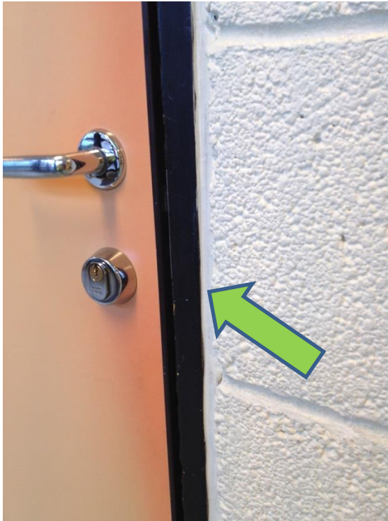
Figur 9 Hvit fugemasse med klorparafiner finnes bl.a. rundt dørene i 1980-delen
