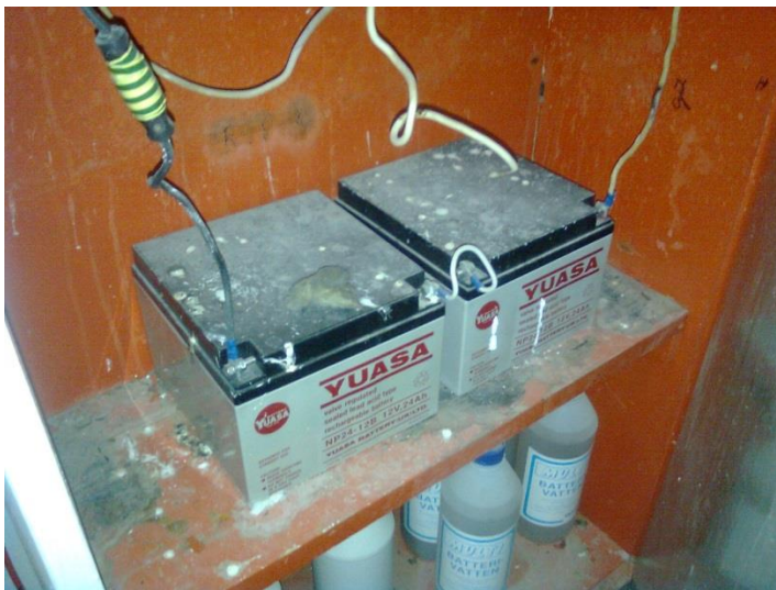
Figur 5 Blybatterier i skap i berederrom
