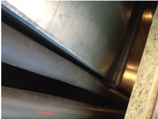
Figur 6 Svart cellegummi rørisolasjon med bromerte flammehemmere. Bildet er tatt over himlingen i 1980-fløyen.
