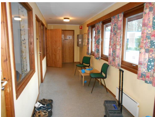
Figur 2 Vinyl gulvbelegg i hele bygningen. Vinduene i yttervegg inneholder klorparafiner.
