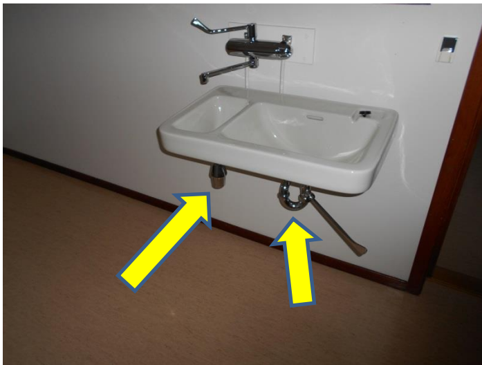
Figur 3 Kvikksølv i vannlåser avmerket med gule piler.
