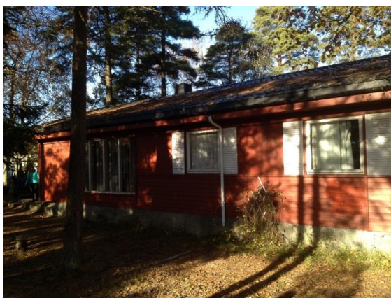
Figur 2 De rødmalte platene mellom vinduene er eternittplater med asbest
