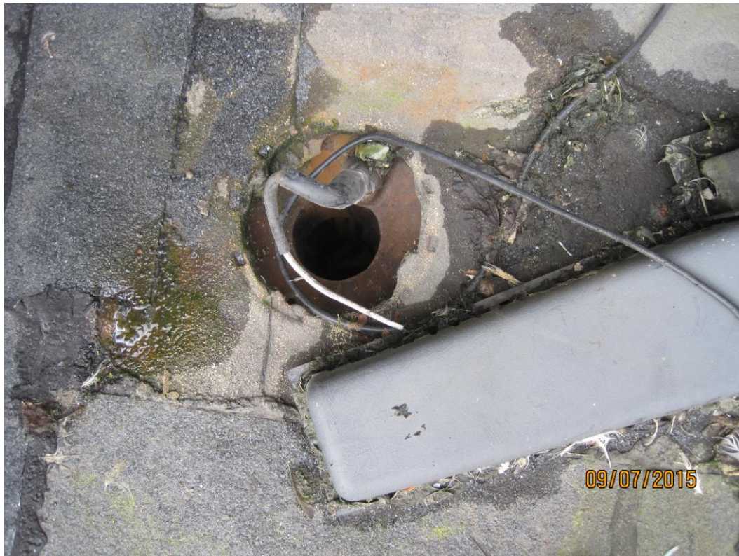
Figur 23: Nærbilde av sluk. (Rambøll)
