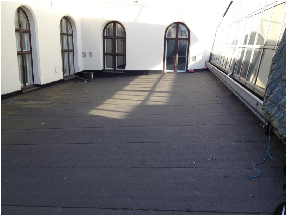
Figur 14: Foto av flatt tak sør, tatt i retning vest (Rambøll)
