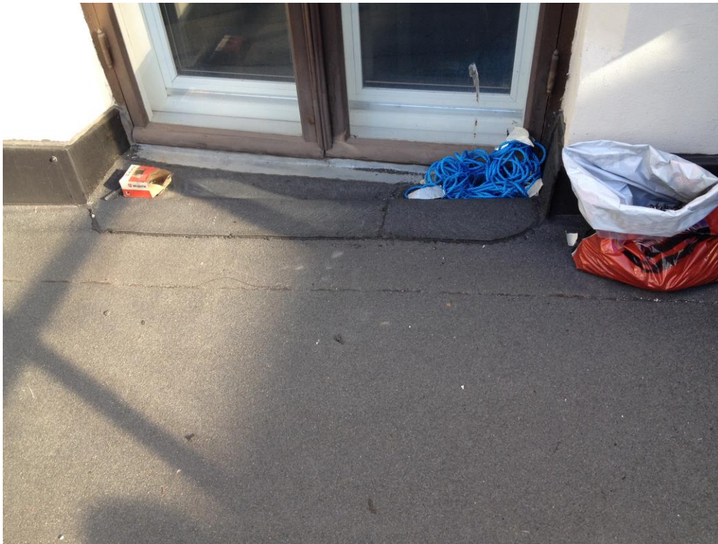
Figur 17: Foto av vindu hvor underkant vindu er under topp tekking på tak. (Rambøll)
