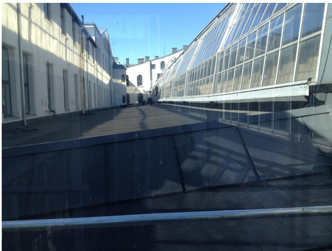
Figur 20: Foto viser avslutning mot lavereliggende tak, tatt i retning vest gjennom vindu/gangbro. (Rambøll)
