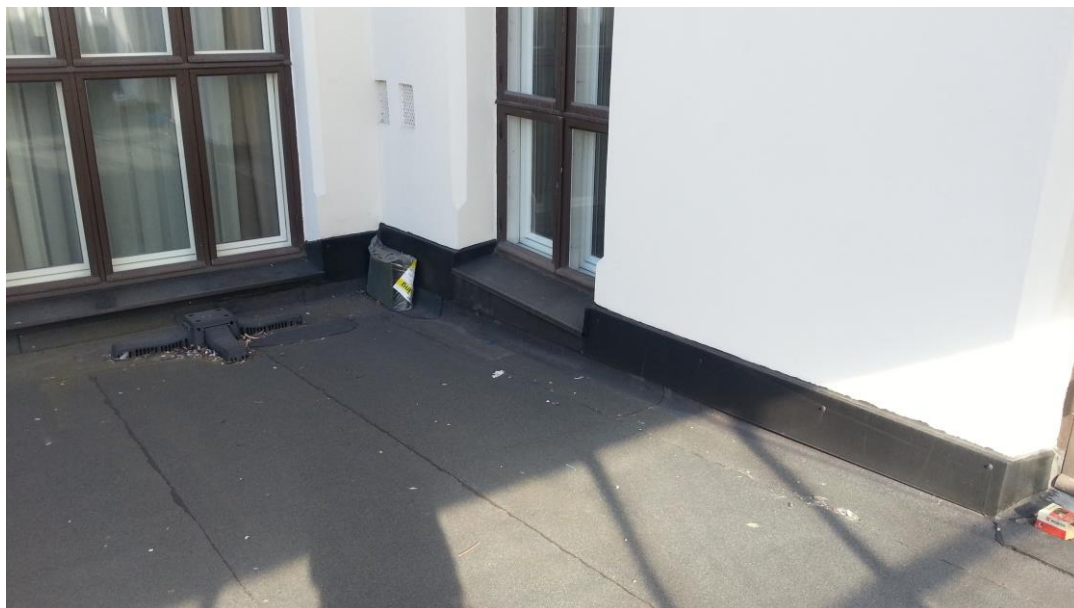
Figur 15: Foto av sluk og overganger mot pusset teglvegg. (Rambøll)
