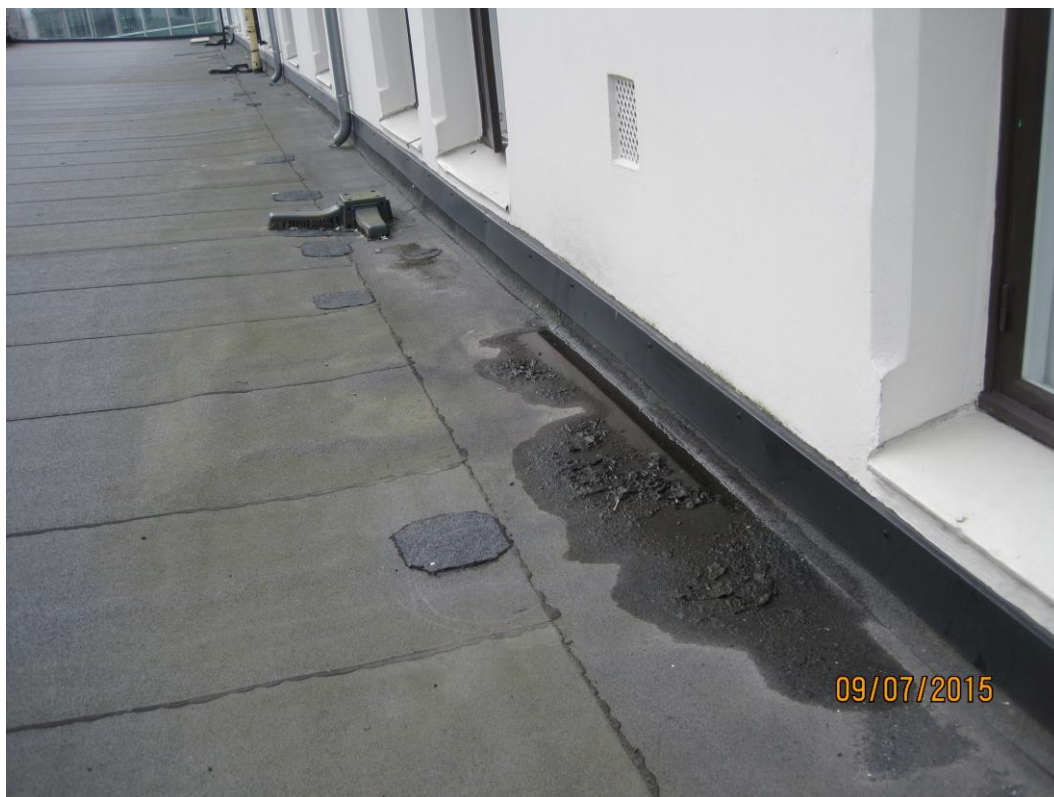
Figur 24: Foto viser stående vann mellom sluk. (Rambøll)
