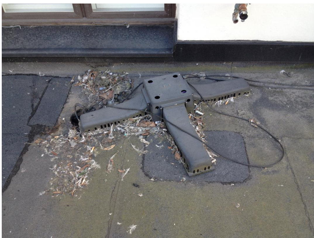
Figur 16: Foto av løv og smuss samlet opp rundt sluk. (Rambøll)
