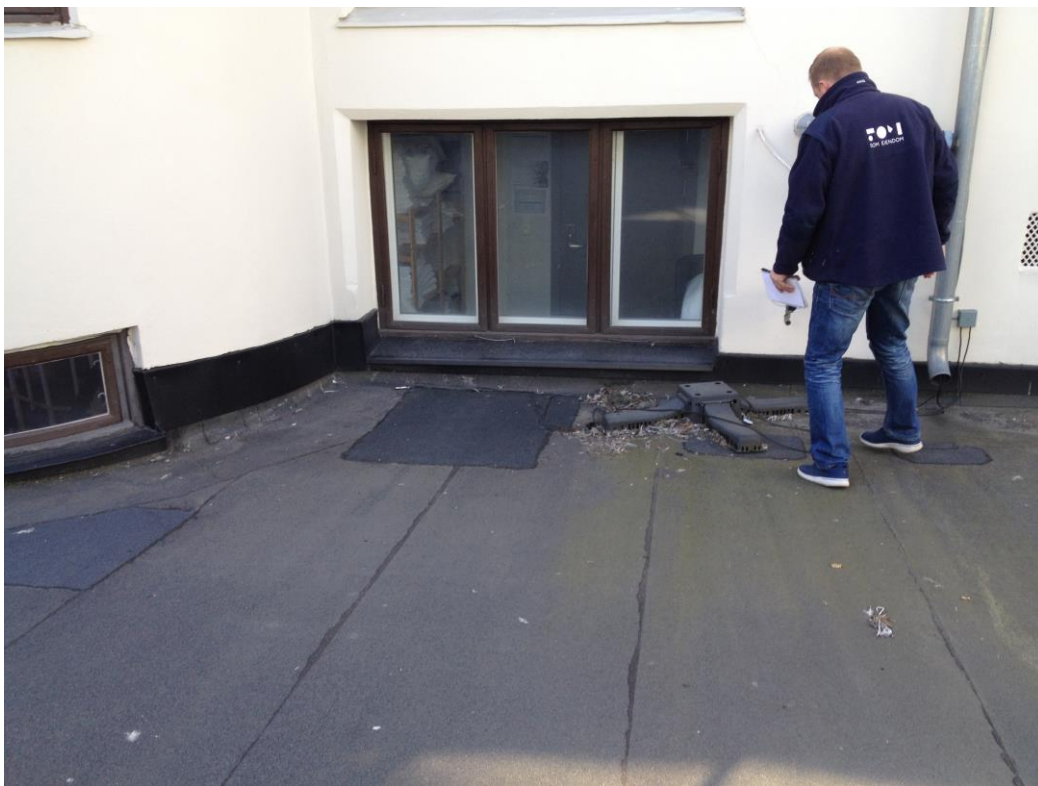
Figur 18: Foto viser lapping av tekking og smuss rundt sluk. (Rambøll)
